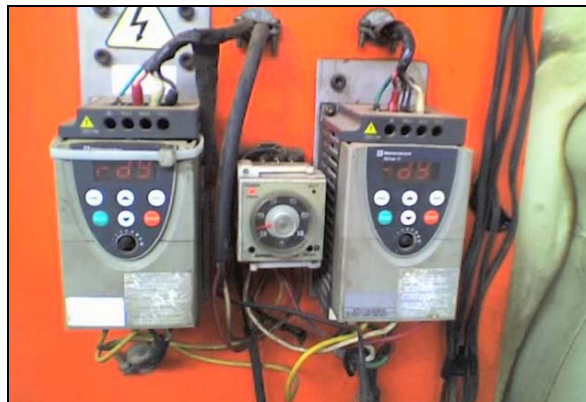
FIGURA 3.3. PARTE ELÉCTRICA CON PUENTES
