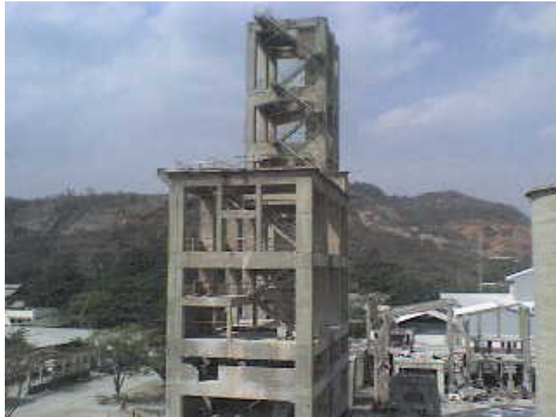
FIGURA 2.2. ESTRUCTURA DE CONCRETO PARA LOS HORNOS, MOLINOS Y CICLONES EN LA TORRE 1 DE LA PLANTA CLINCAL (“SAN EDUARDO” HOLCIM-ECUADOR).
