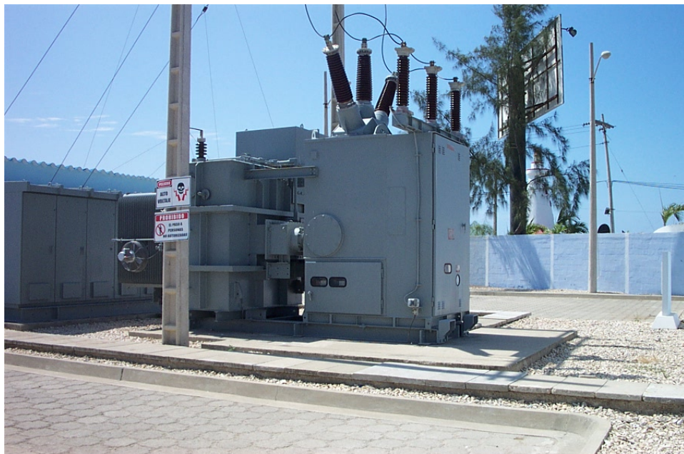
FIGURA 3.10. TRANSFORMADOR DE ALTA TENSIÓN ( 5 MVA)
