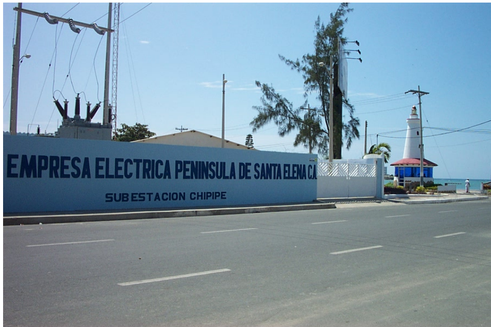
FIGURA 3.9. SUBESTACIÓN ELÉCTRICA CHIPIPE
