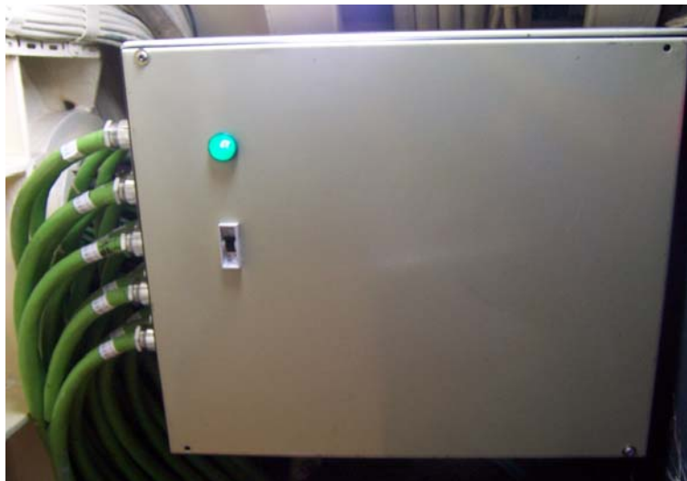
Figura 2.2.- Tablero eléctrico de voltaje
