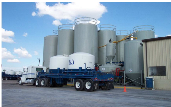
Figura 1.12 - Almacenamiento de cemento seco. Fuente: BJ-Services.
