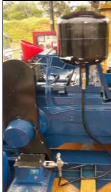
FIGURA 2.11: Bomba y bombona de recepción de químicos FUENTE: Elvis Gómez López y Nixon Vilcaguano Changoluisa
