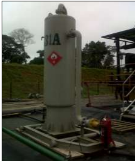
FIGURA 2.15: Scrubber de gas en la locación FUENTE: Elvis Gómez López y Nixon Vilcaguano Changoluisa
