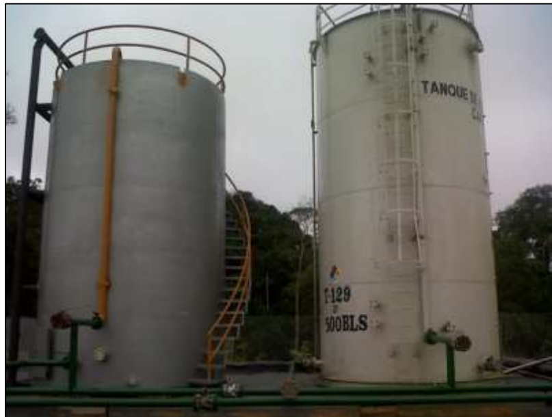
FIGURA 2.16: Tanques de almacenamiento de petróleo FUENTE: Elvis Gómez López y Nixon Vilcaguano Changoluisa
