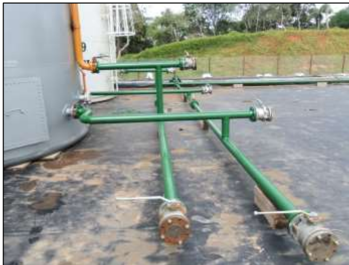
FIGURA 2. 7: Manifold de conexión de los tanques de almacenamiento
