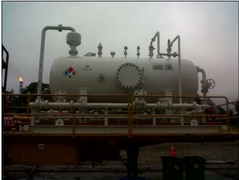
FIGURA 2. 13: Separador trifásico en la MTU
