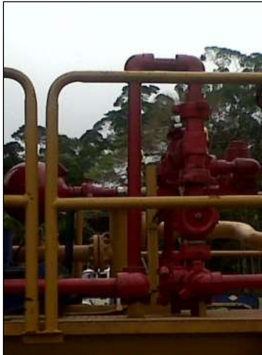
FIGURA 2.12: Manifold Inyección/Producción FUENTE: Elvis Gómez López y Nixon Vilcaguano Changoluisa
