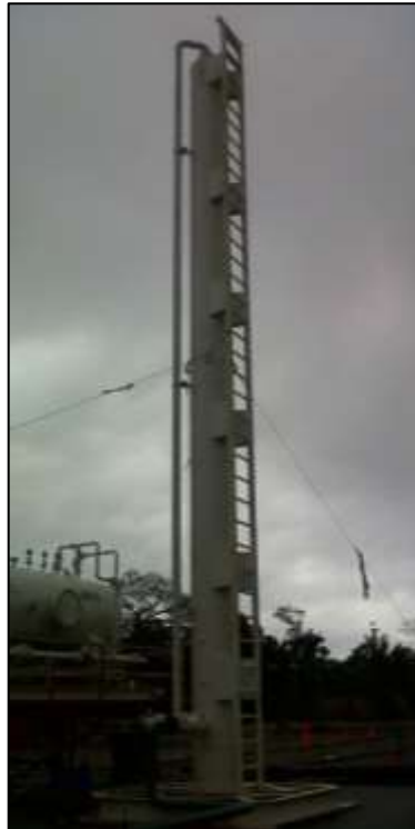
FIGURA 2. 14: Bota de gas en la locación FUENTE: Elvis Gómez López y Nixon Vilcaguano Changoluisa
