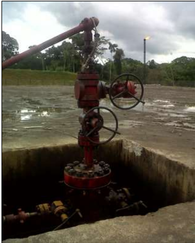
FIGURA 2.5: Cabezal de producción del pozo AMD1 FUENTE: Elvis Gómez López y Nixon Vilcaguano Changoluisa
