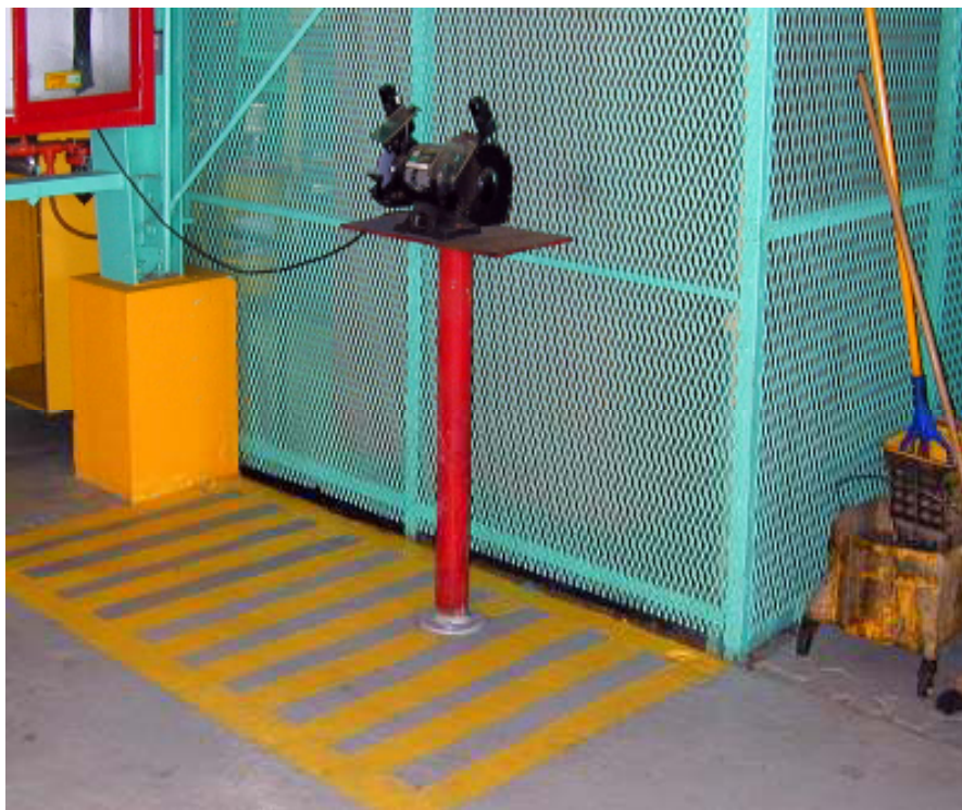
Figura 3.14 Situación recomendada: Ubicación de esmeriladora
