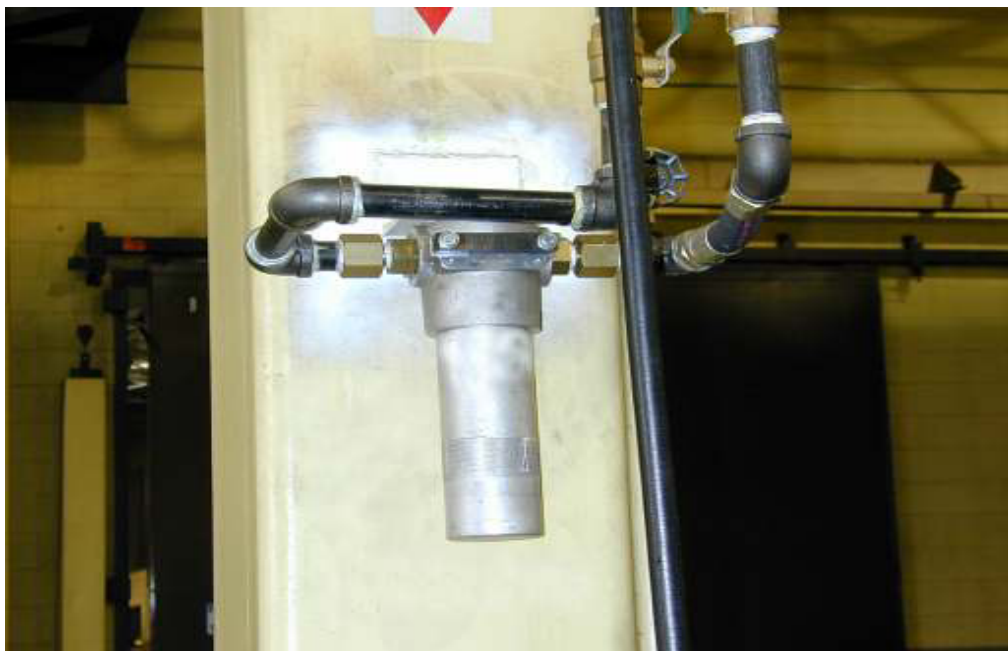
Figura 3.13 Situación recomendada: Abastecimiento de aceite
