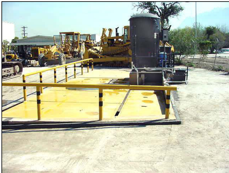
Figura 3.3 Situación Recomendada: Sistema de separación de aceite y lodo.
