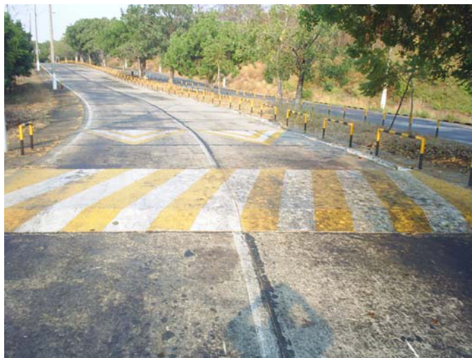
Foto 6.2.1. Demarcación de reductor de velocidad y flechas en su proximidad
