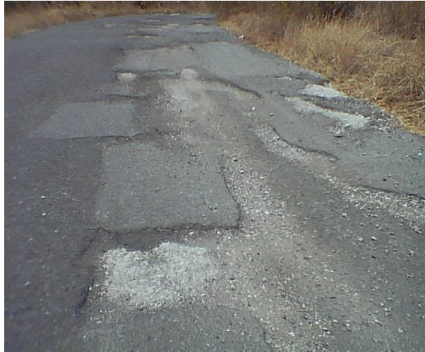
Foto 2.3.6.12. Capa de rodadura desprendida del firme
