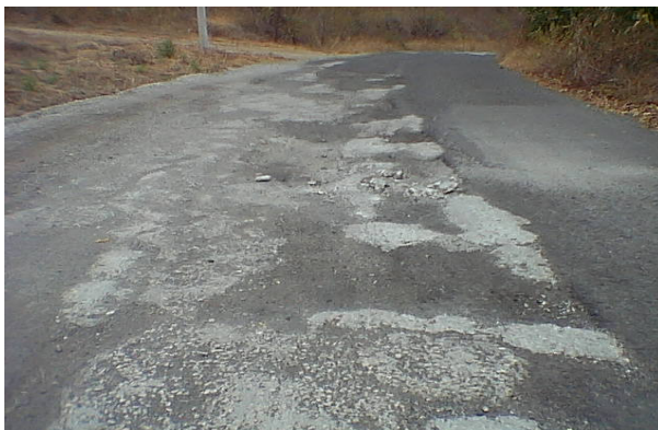
Foto 1.3.3. Estado de capa de rodadura (Abscisa 0+570)
