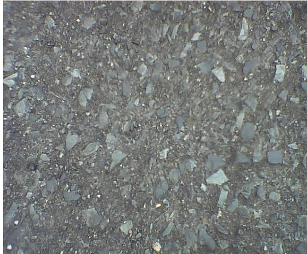
Foto 2.3.6.6. Desgaste de los áridos debido al efecto de abrasión por el tránsito
