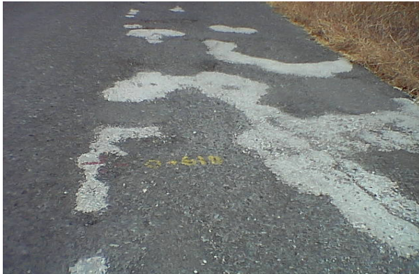
Foto 1.3.7. Baches rellenos de hormigón hidráulico
