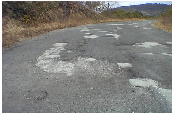
Foto 1.3.11. Inexistencia de peraltes en curvas horizontales
