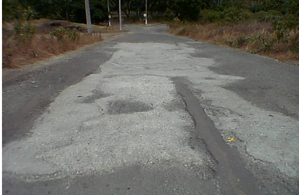
Foto 1.3.4. Estado de capa de rodadura (Abscisa 0+730)
