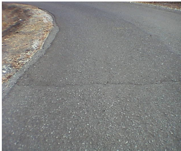
Foto 2.3.6.5. Línea de rotura transversal al eje de la carretera
