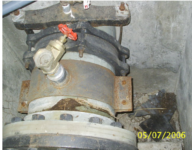
Foto 3.1.1.3. Válvula de compuerta existente
