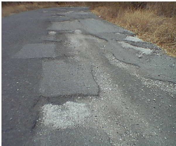
Foto 2.3.6.1. Estado actual de la superficie de rodadura del pavimento flexible
