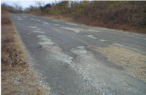
Foto 1.3.1. Estado de capa de rodadura (Abscisa 0+100)
