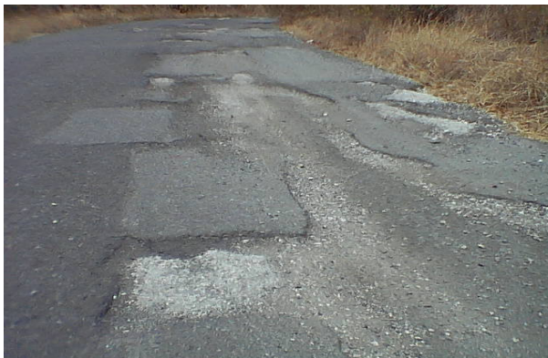
Foto 1.3.2. Estado de capa de rodadura (Abscisa 0+270)
