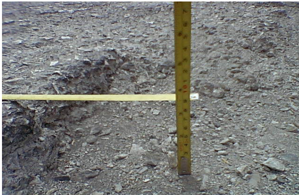
Foto 1.3.5. Baches existentes en la vía
