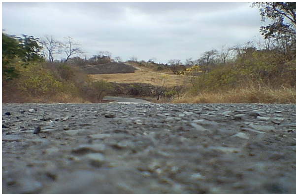
Foto 1.3.6. Agregados expuestos en superficie de rodadura
