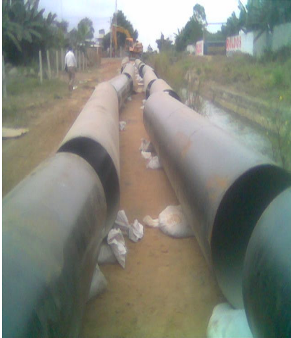
FIGURA 1.1 RESEÑA DEL MONTAJE DE LOS SEGMENTO EN SECTOR ALEDAÑO A LA PLANTA DE PROCESAMIENTO DE AGUA EN MACHALA
