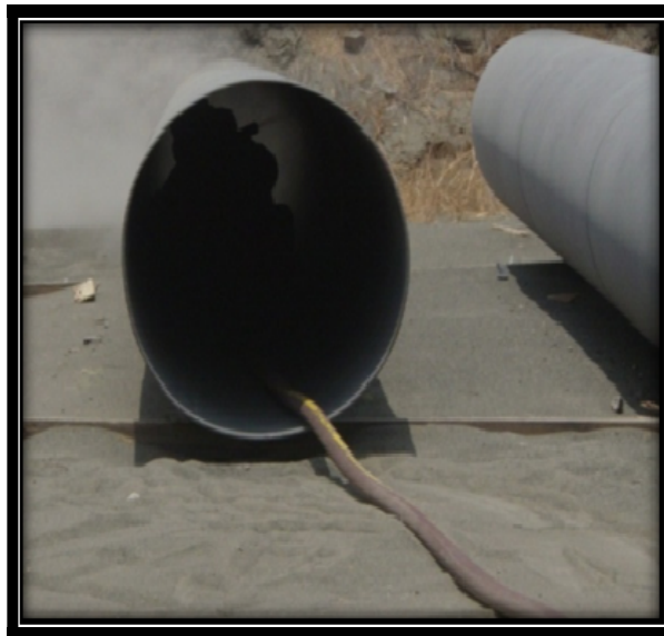
FIGURA 2.15 SISTEMA DE ARENADO POR CHORRO DE ARENA A PRESIÓN DE AIRE (SANDBLASTING) LADO INTERNO
