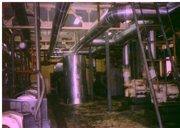
Figura 2.11 Aislamiento de Tuberías y Tanques
