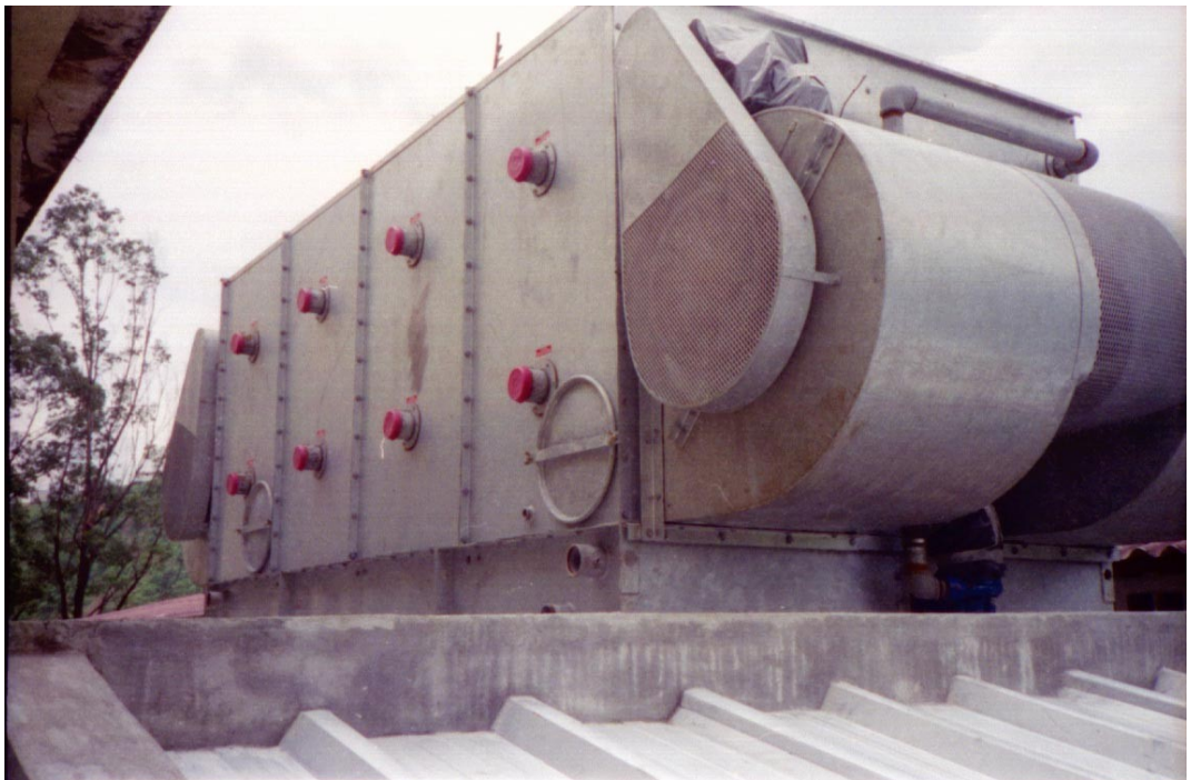
Figura 2.4. Condensador Evaporativo VILTER VGC 360
