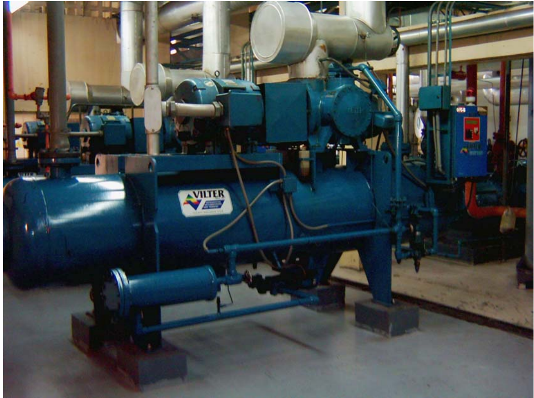
Figura 2.2 Compresor de Tornillo VSS 1051
