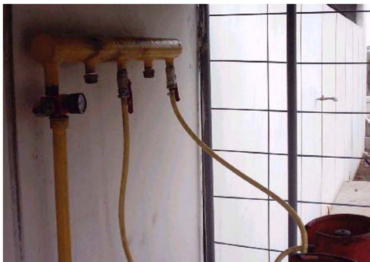
Foto 10: válvula reguladora de GLP
