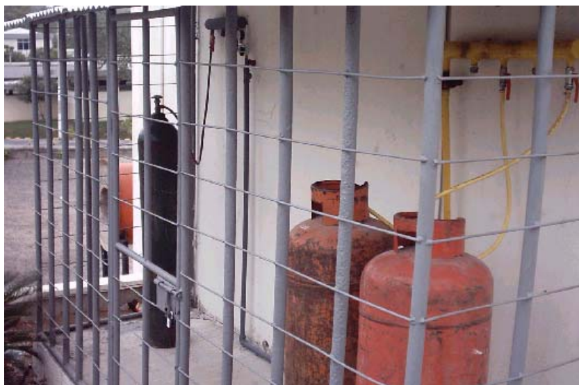
Foto 8: Instalaciones de combustibles
