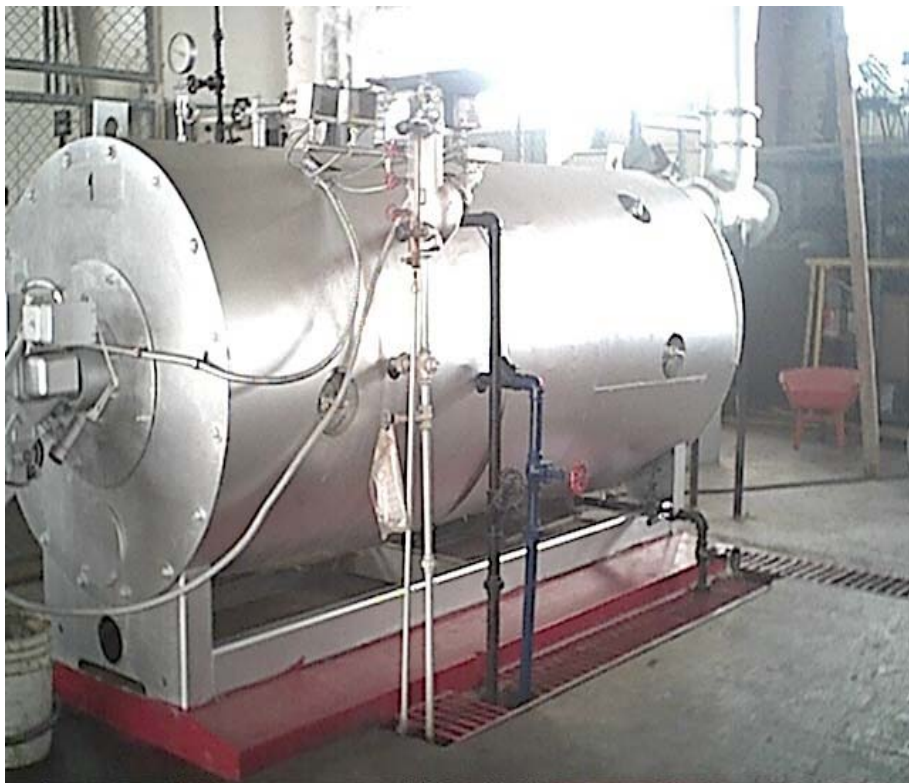
Figura 3.7 : Mediante las purgas de superficie ( tubería negra ),se está eliminando condensado hacia los desagües, desperdiándose energía , que puede ser recuperada.
