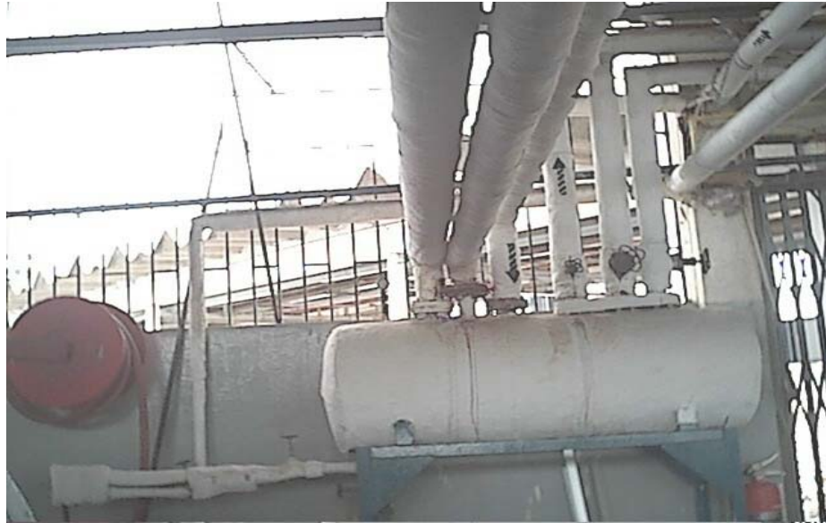
Figura 6.6 : Recubrimiento aislante que contiene asbesto.
