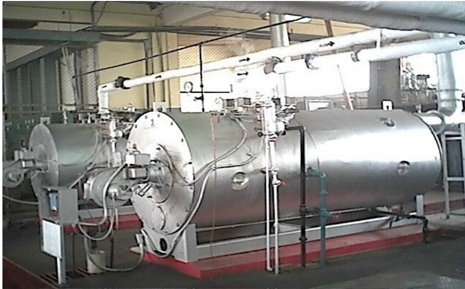
Figura 7.1 : Ausencia de trampas de vapor en tuberías principales que salen de las calderas.
