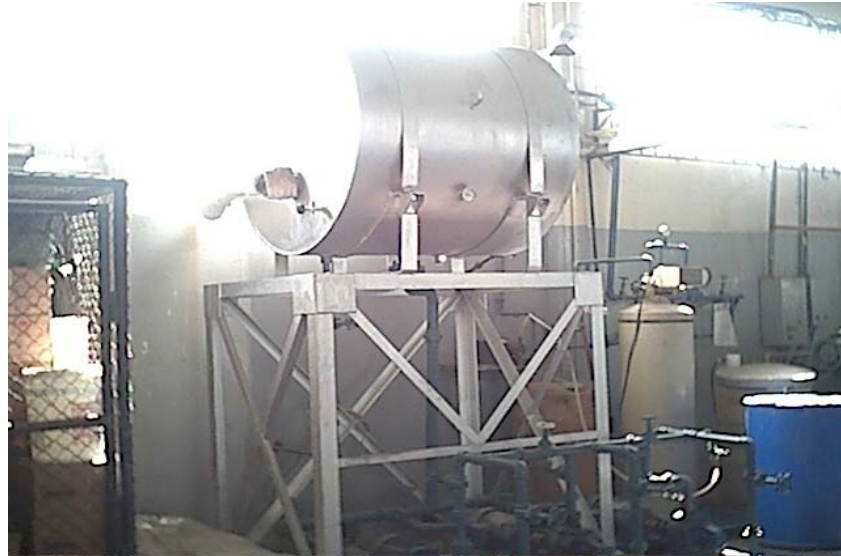
Figura 3.1 : Tanque existente para agua de alimentación .
