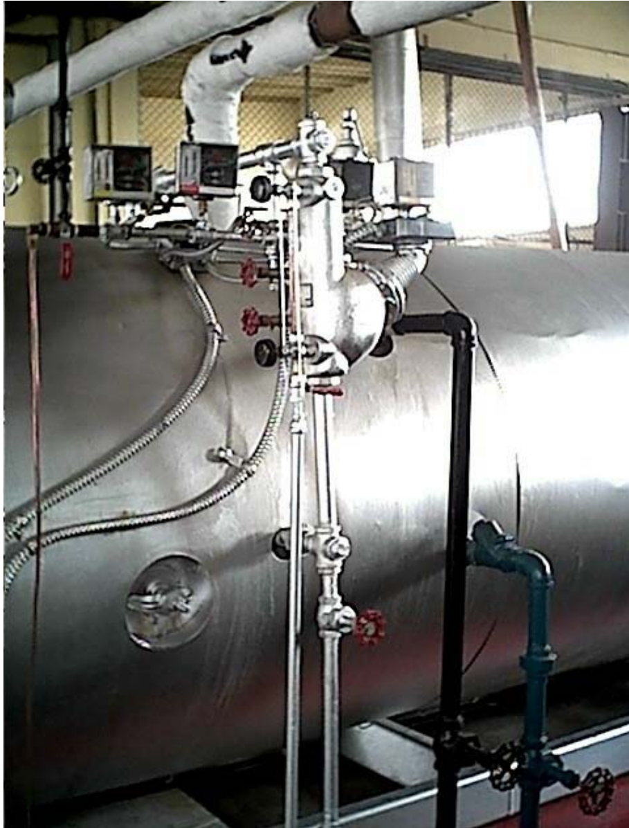
Figura 5.2 : Control de bajo nivel de agua con interruptor y alarma McDonnell tipo No. 150.
