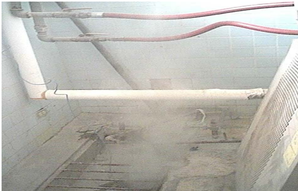
Figura 7.2 : Ausencia de trampas de vapor en lavandería.
