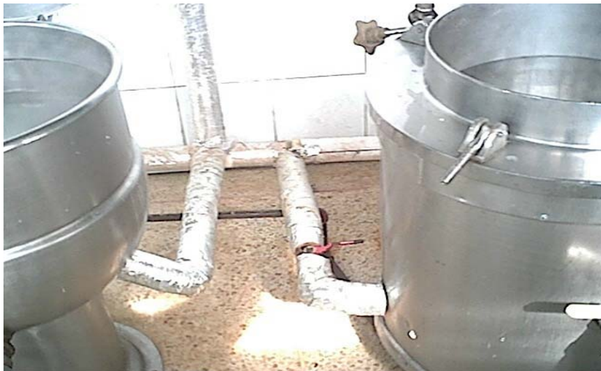
Figura 7.3 : Ausencia de trampas de vapor en marmitas.
