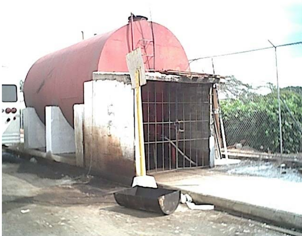
Figura 4.1 Tanque de almacenamiento del combustible.
