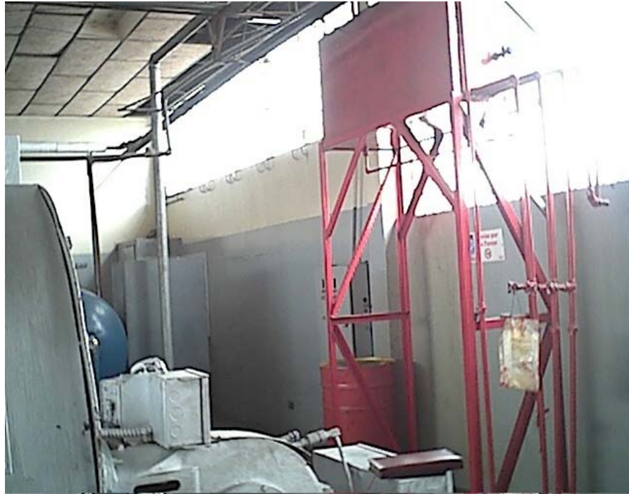
Figura 4.2 : Tanque diario de combustible.
