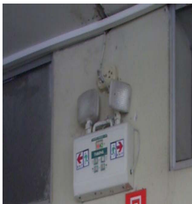
FIGURA 3.5 LUZ DE EMERGENCIA
