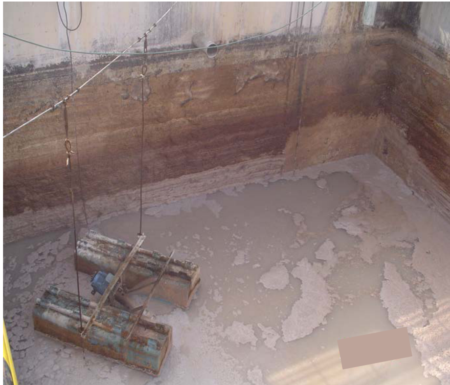
Figura # 4.2.- Tanque de homogenización
