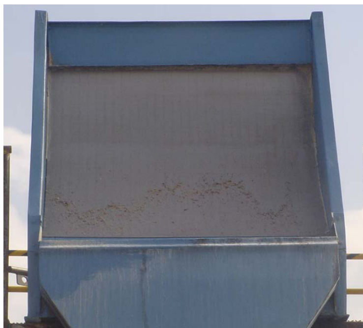
Figura # 4.1.- Cámara de rejas
