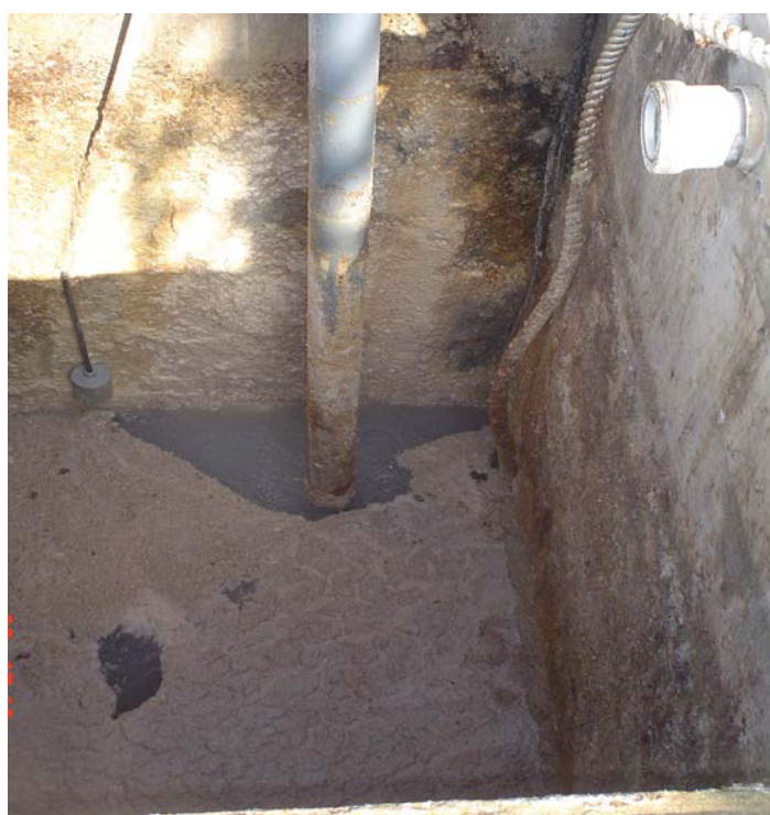
Figura # 4.1.- Pozo de bombeo
