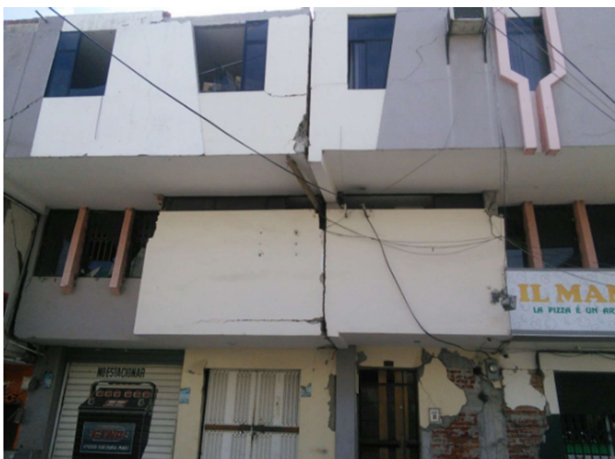
Figura 3.6. Golpeteo entre edificaciones, sismo de Pedernales 2016. Fuente: Autores, 2016.
