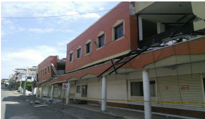
Figura 3.2. Vista de edificación larga, sismo de Pedernales 2016. Fuente: Autores, 2016.
