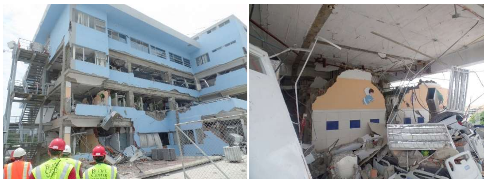
Figura 1.1. Hospital del IESS de Manta tras el sismo del 2016.
