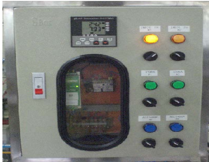
Figura 3.21 Parte externa del panel de control
