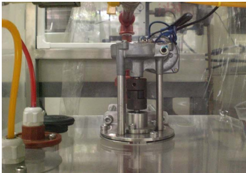
Acople mecánico para el agitador del tanque inicial
