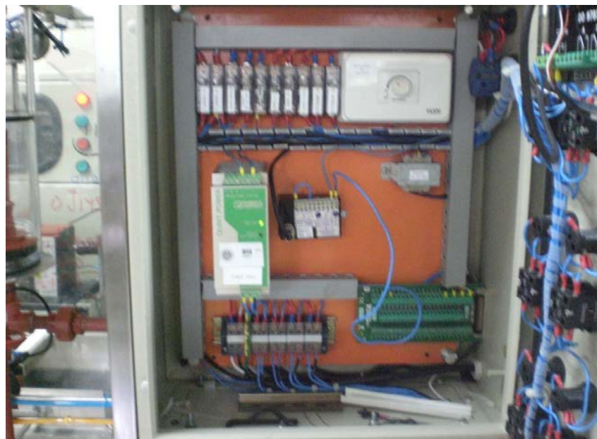
Parte Interna del Panel de Control
