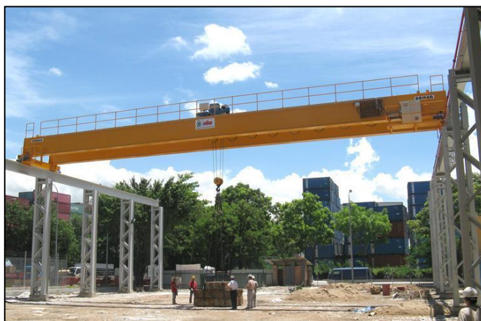
Figura 2.3. Puente Grúa con estructura de soporte.
