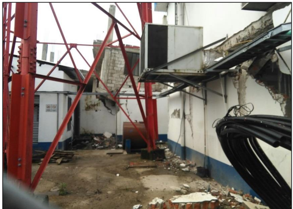
Figura 1.5: Daños en la Central Telefónica, CNT-Pedernales
