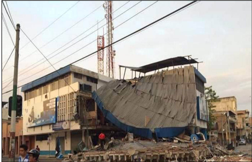
Figura 1.4: Central Telefónica destruida, CNT-Portoviejo
