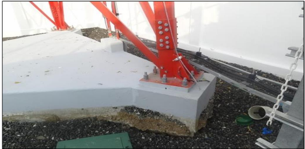
Figura 1.10: Desnivel y cuarteamientos en la base de la torre auto-soportada de telecomunicaciones, CNT-Cojimies
