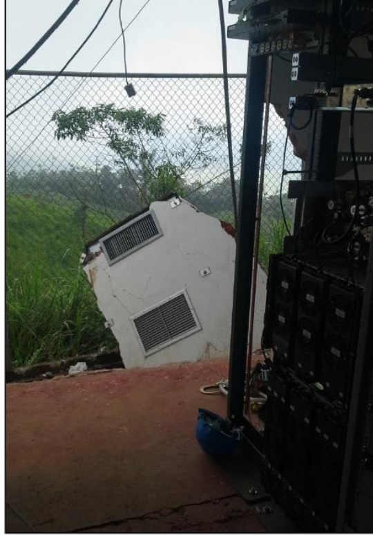
Figura 1.6: Estación repetidora destruida, CNT-Cerro Nueve-Jama
