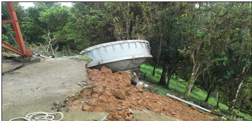
Figura 1.11: Antena caída y daño en la infraestructura en la base de la torre de telecomunicaciones, CNT-El Matal
