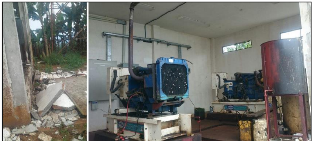
Figura 1.7: Infraestructura de estación repetidora desplomada y daños en equipos de telecomunicaciones, CNT-Cerro Nueve-Jama
