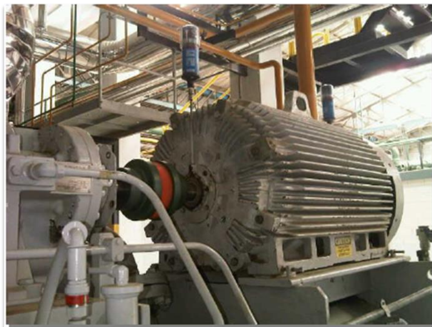
Figura 3.4. Motor Eléctrico Compresor 8
