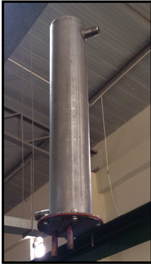
Figura 5.3. Condensador Ubicado en Unidad de Destilación
