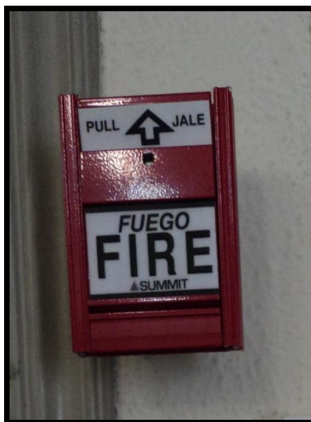
Fig. 2.15 Botón para la alarma contra incendio
