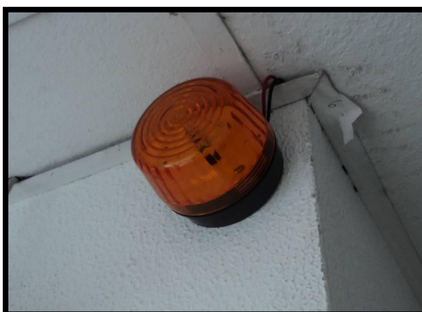
Fig. 2.16 Alarma contra incendio
