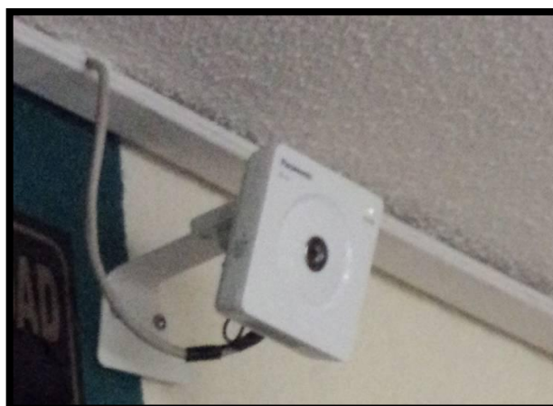
Fig. 2.8 Cámara de Vigilancia
