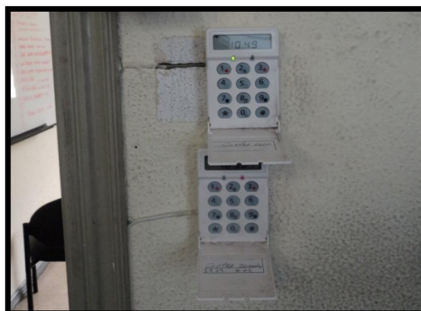
Fig. 2.12 Alarma de Seguridad (Abierta)
