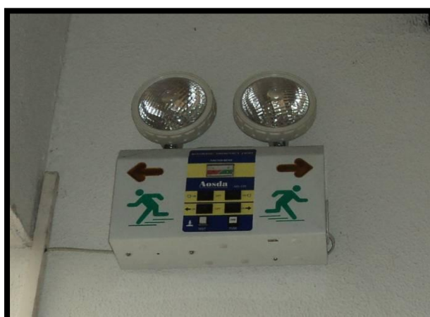
Fig. 2.21 Línea de iluminación
