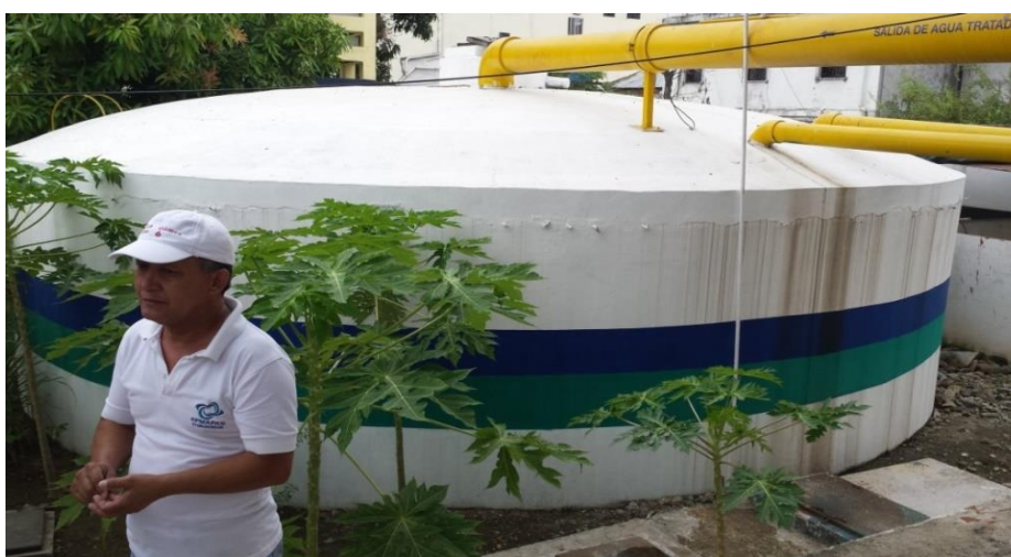
Figura 3.6 Tanque Reservorio Fuente: Celleri, C., Peñafiel, A., 2016.
