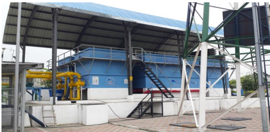
Figura 3.5 Caseta de motores Quifase Fuente: Celleri, C., Peñafiel, A., 2016.
