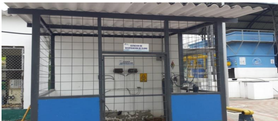
Figura 3.3 Estación de Dosificación de Cloro Fuente: Celleri, C., y Peñafiel, A., 2016.
