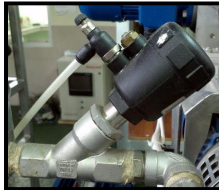
Figura 3.13: Válvula con control neumático [18]
