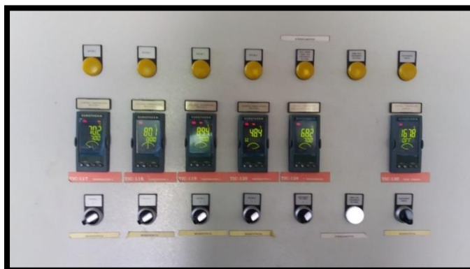
Figura 3.9: Vista del tablero 3 con los controladores de temperatura [18]
