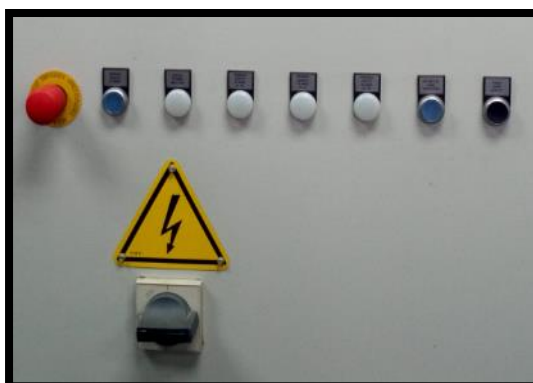
Figura 3.1: Tablero eléctrico, puerta 1 [18]
