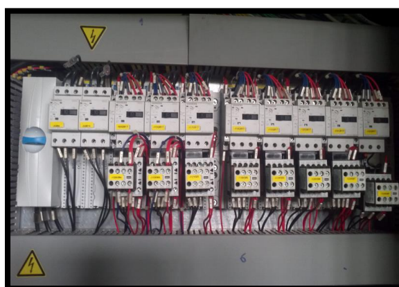
Figura 4.3: Grupos de contactores [18]
