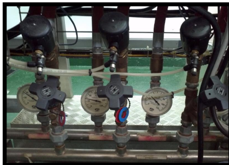
Figura 4.9: Válvulas neumáticas y manómetros de presión [18]
