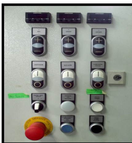
Figura 3.11: Panel de control para operador [18]
