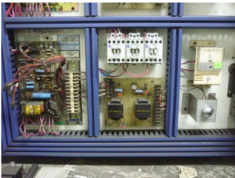
Foto 2.6 Tablero de control electrónico Dynamatic modelo 4000
