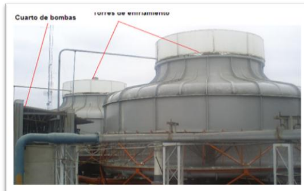
Figura 1.8: Sistema de Climatización.
