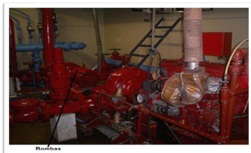
Figura 1.9: Sistema Contra incendios – Cuarto de Bombas.
