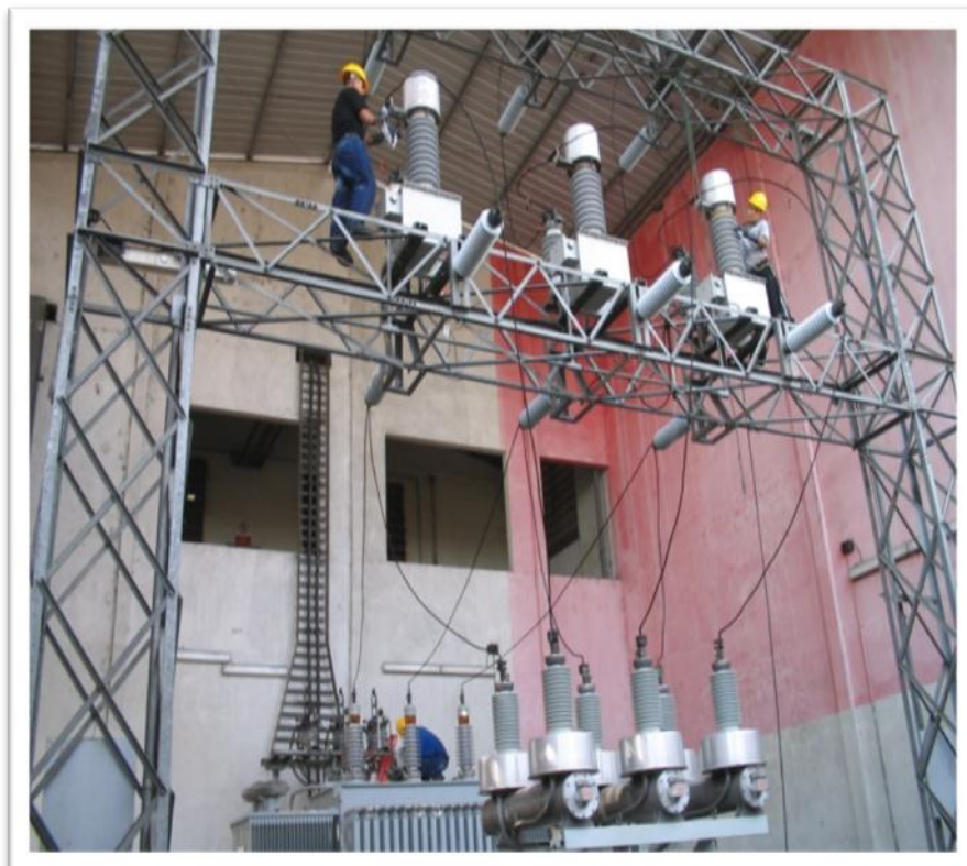
Figura 1.2: Subestación Principal 69/13.2 KV.
