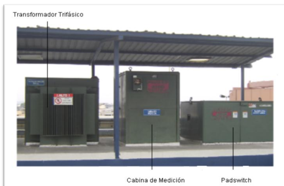
Figura 1.5: Plataforma-Transformación y Control.
