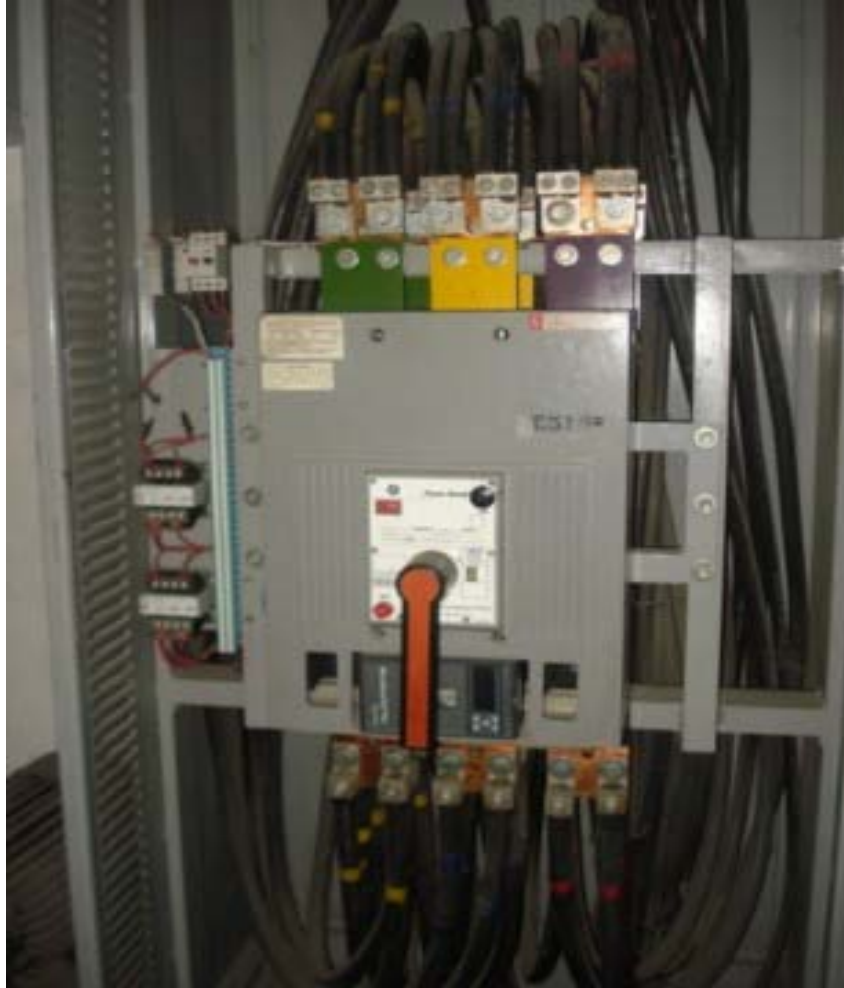
Breaker General Electric 220V. Ubicación centro de carga del corredor "G"
