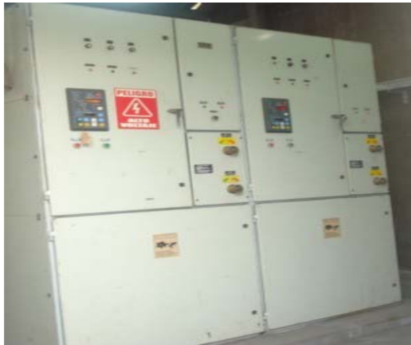
Celda # 4 y 5. Dentro de ellas se encuentra la barra Principal de 13,2 KV
