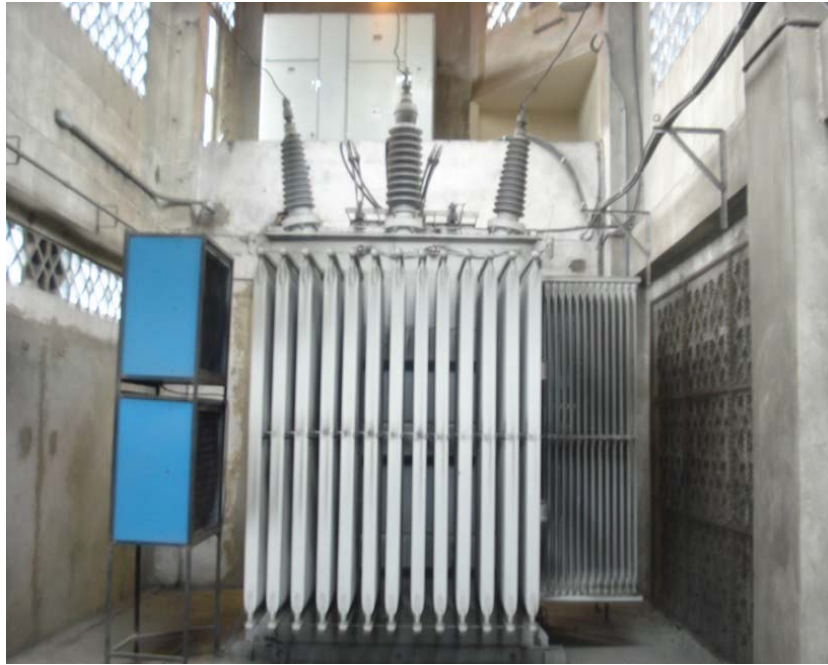
TR0: Transformador Principal 69/13,2KV
