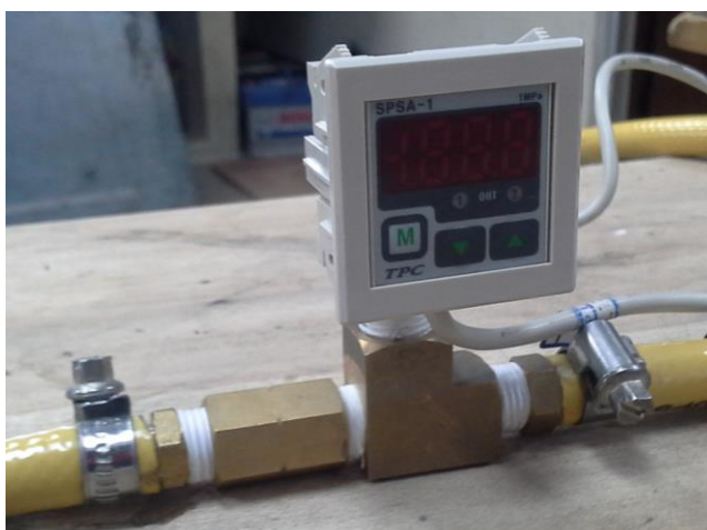
FIGURA 26. Medidor SPSA-1 instalado
