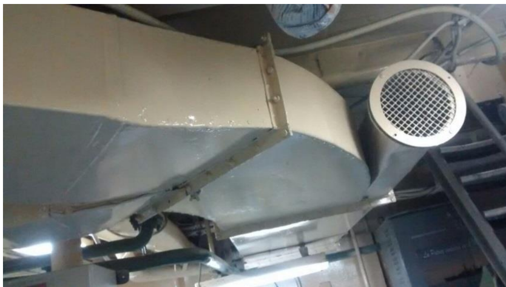
Figura 4. 2: Ventilaciones sala de máquinas B.A.E “Chimborazo”
