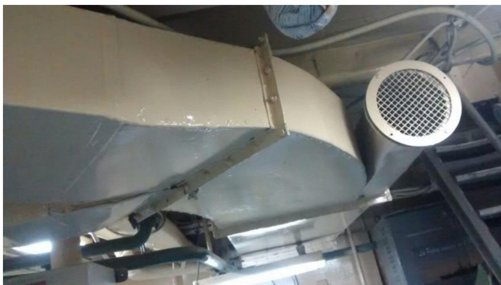
Figura 4. 2: Ventilaciones sala de máquinas B.A.E “Chimborazo”
