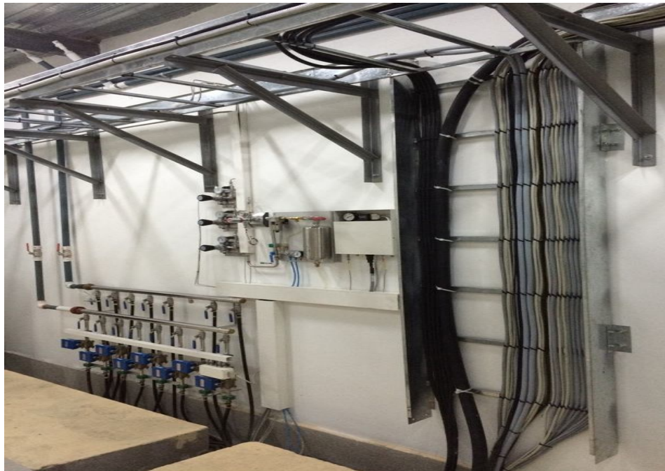
Figura 1.5 Cableado en escalerilla
