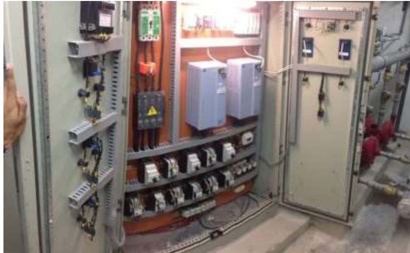
Figura 2.1: Tablero de control para 3 bombas de 20HP con dos variadores, vista interior.
