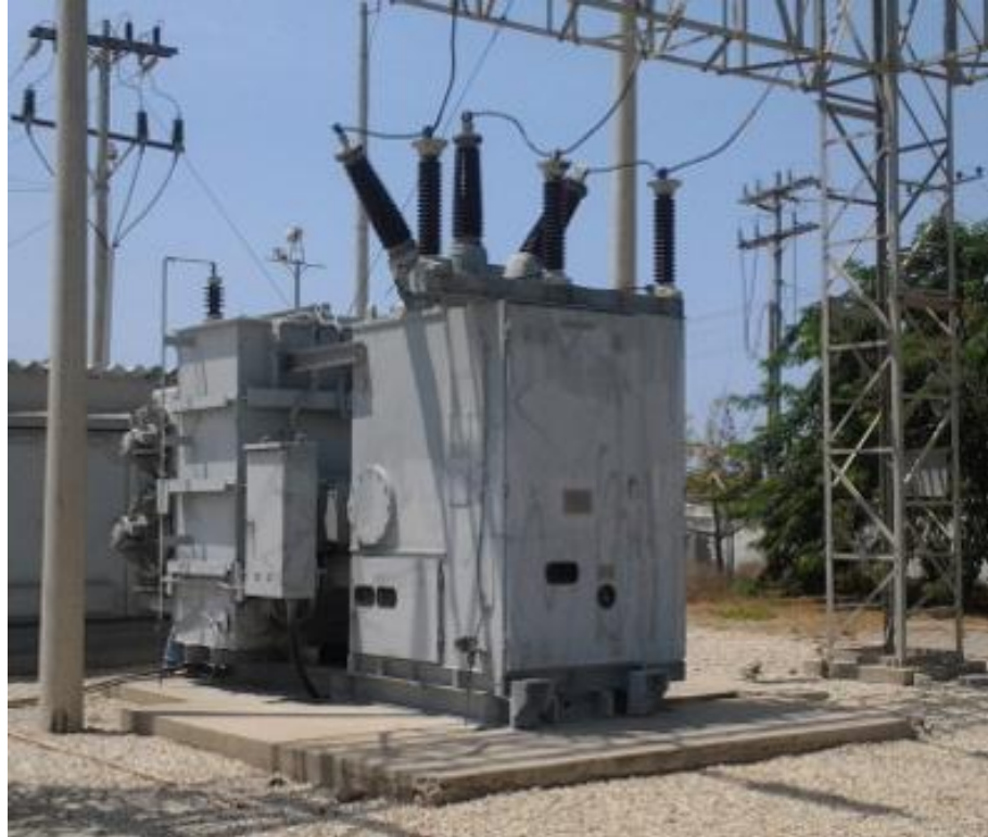
Figura 1.10 Transformador de Potencia
