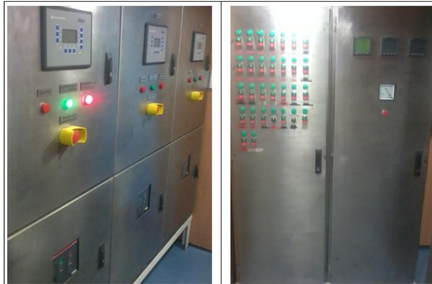
Figura 4.2: Tableros principales de distribución.
