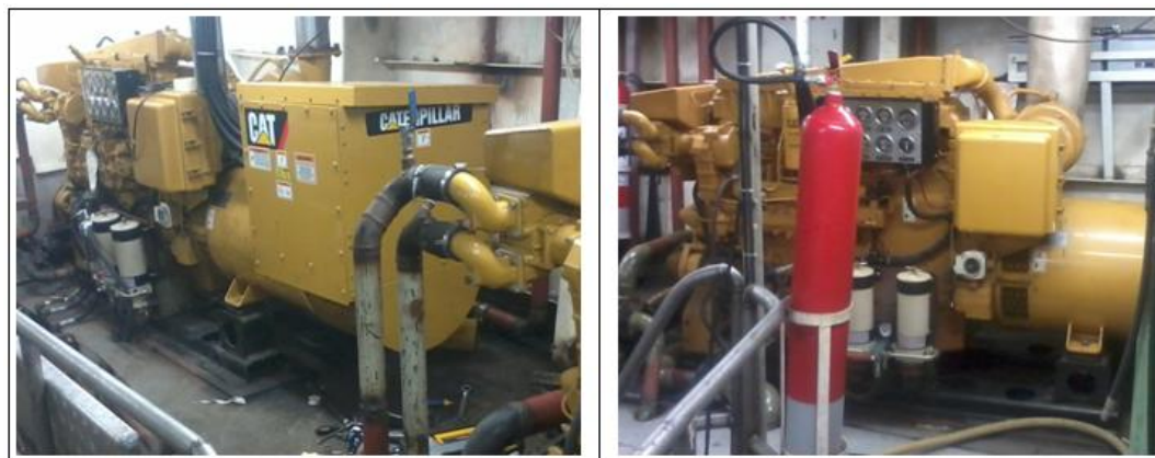
Figura 4.1: Grupos electrógenos CATERPILLAR.
