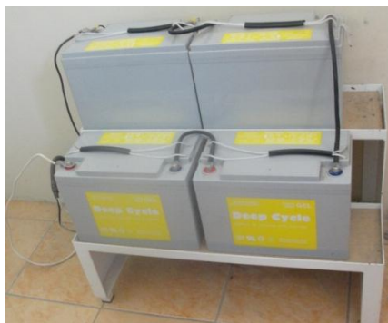
Figura 1.15 Banco de baterías.
