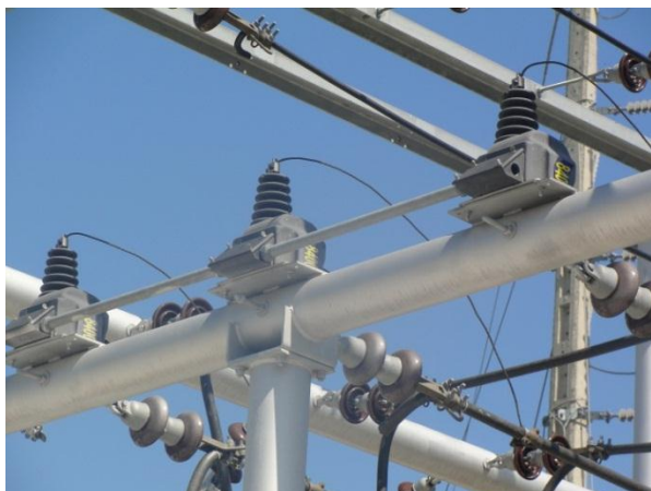
Figura 1.13 Transformadores de Potencial.
