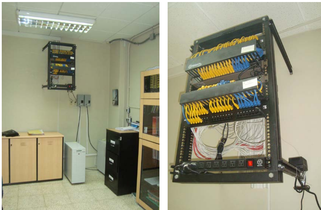
Figura 4.1: Laboratorio del CEN, mostrando Rack con switches , UPSs y acometidas eléctricas Fuente:CEN
