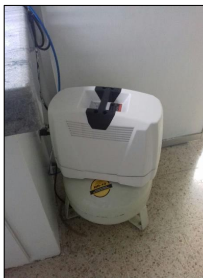
Figura 2.9: Compresor de Aire CIBE ESPOL
