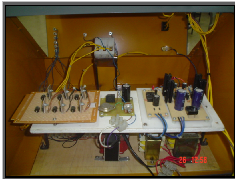
Fig. 4.3 Vista superior de los circuitos del inversor construido.
