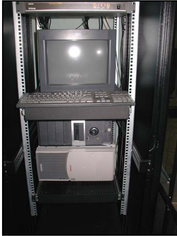
Fig. 5.2.- Servidores de Base de Datos y aplicaciones
