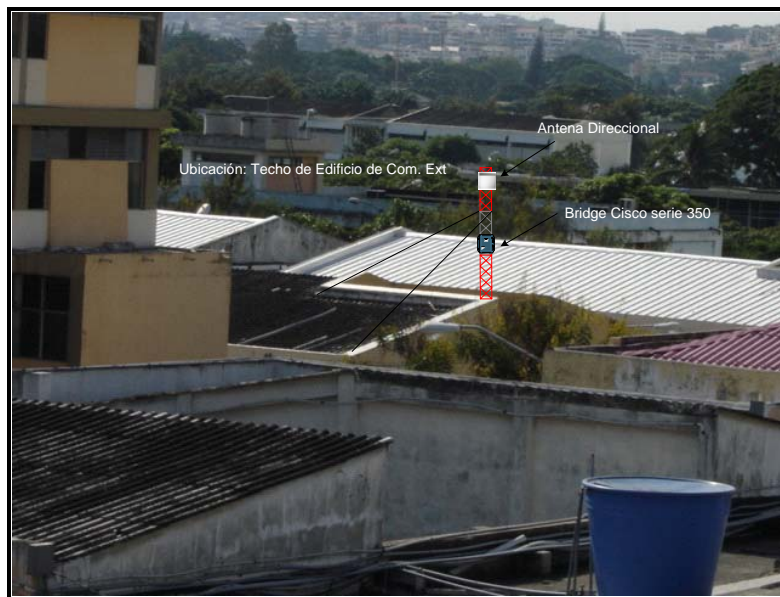
Fig. 6.5 Ubicación de Antena en Edificio Com. Ext.
