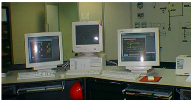
Figura 2.1.-Consolas de Supervisión
