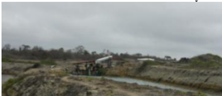
Figura # 11. Estación de bombeo en la vía Puerto Cayo
