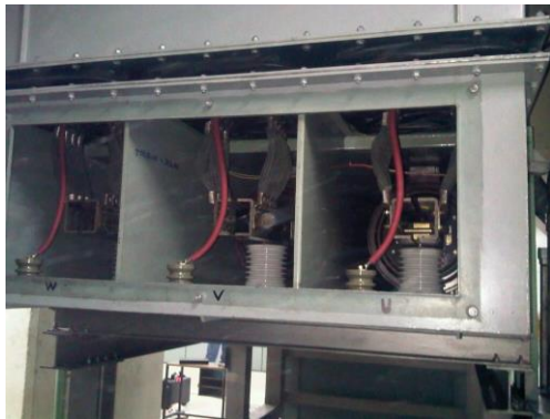
Figura 3. Acopladores capacitivos instalados en los terminales del generador.
