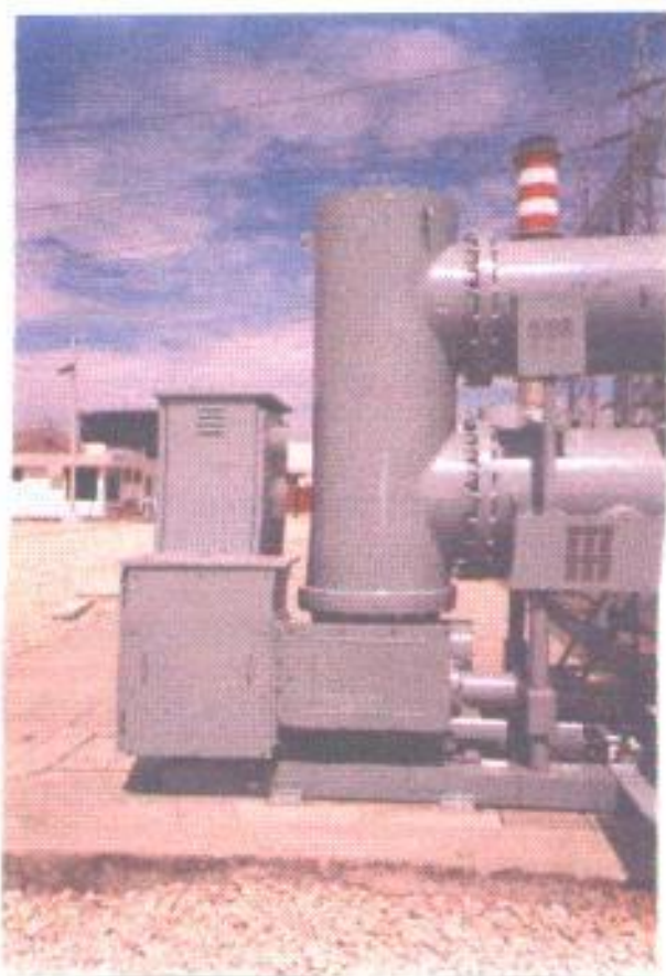
FIG 2.1 Tipos de subestaciones encapsuladas presentes en la Zona Occidental TRANSELECTRIC S.A. ENVOLTURA MONOFÁSICA Y ENVOLTURA TRIFÁSICA
