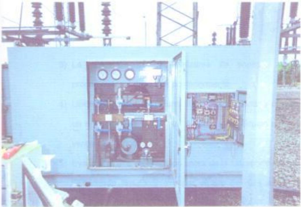
FIG. 4.17 Vista frontal de la máquina de tratamiento de SF 6
