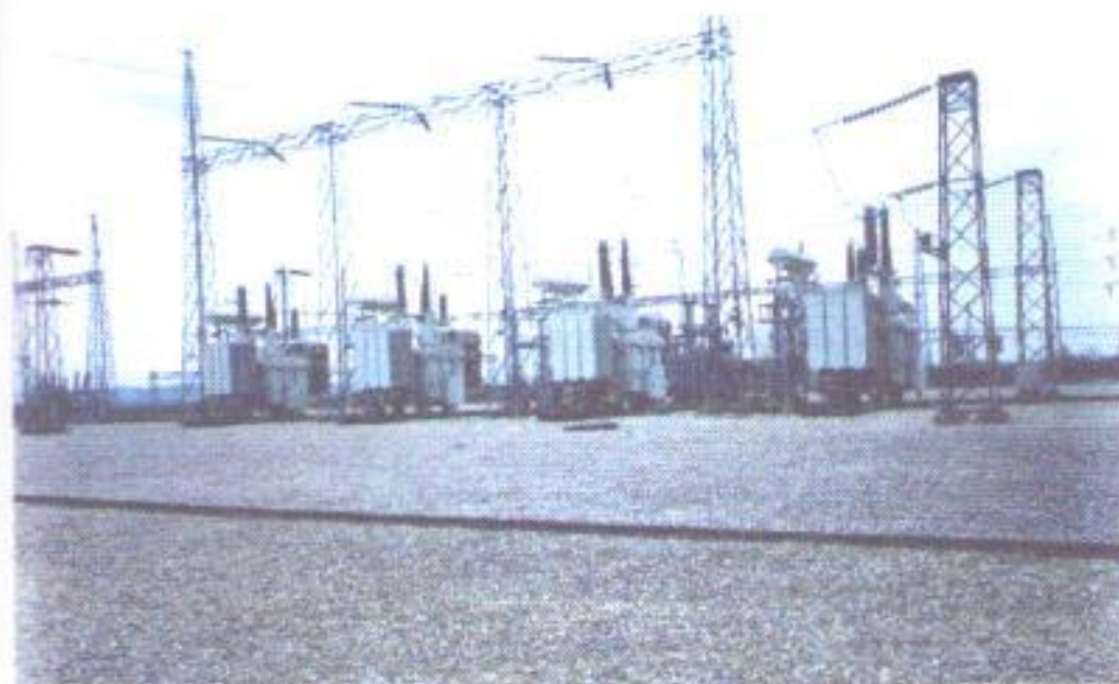
FIG. 2.2 Vista de Bancos de Autotransformadores monofásicos 138/69/13.8 KV y 230/138/13.8 KV
