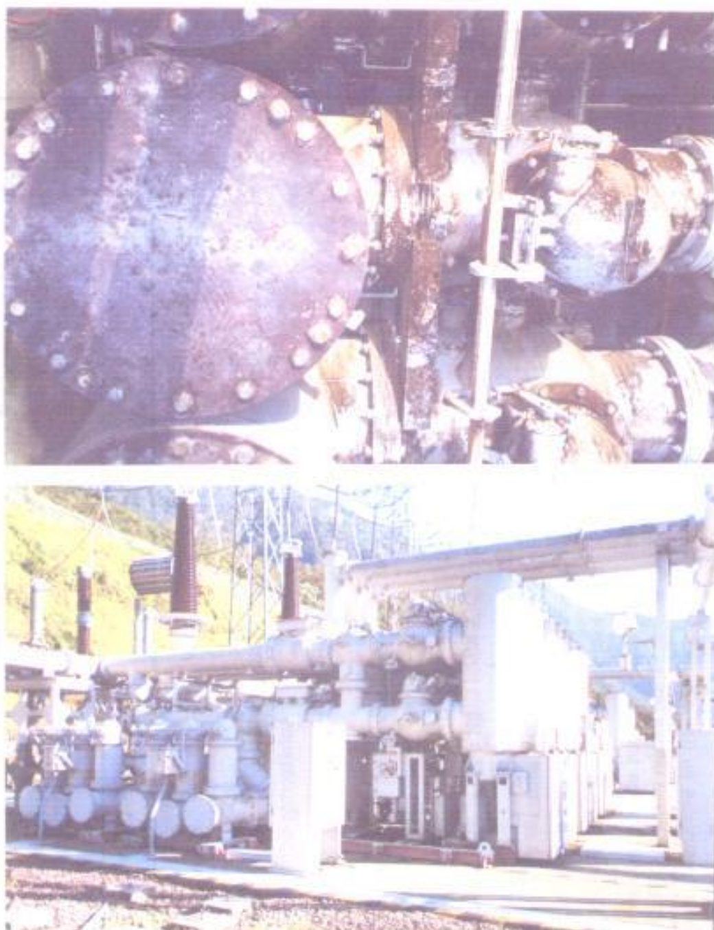
FIG. 4.18 Vista de las zonas afectadas (seccionadores) y vista general de la posición afectada
