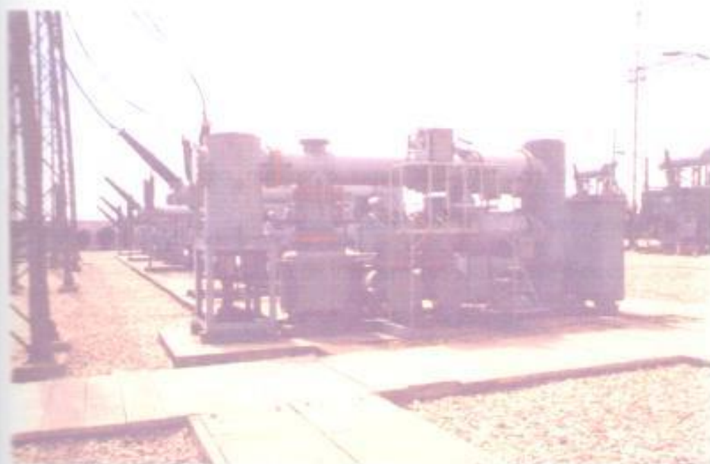
FIG. 4.3 Posición encapsulada (GIS) 138 KV Subestación Trinitaria
