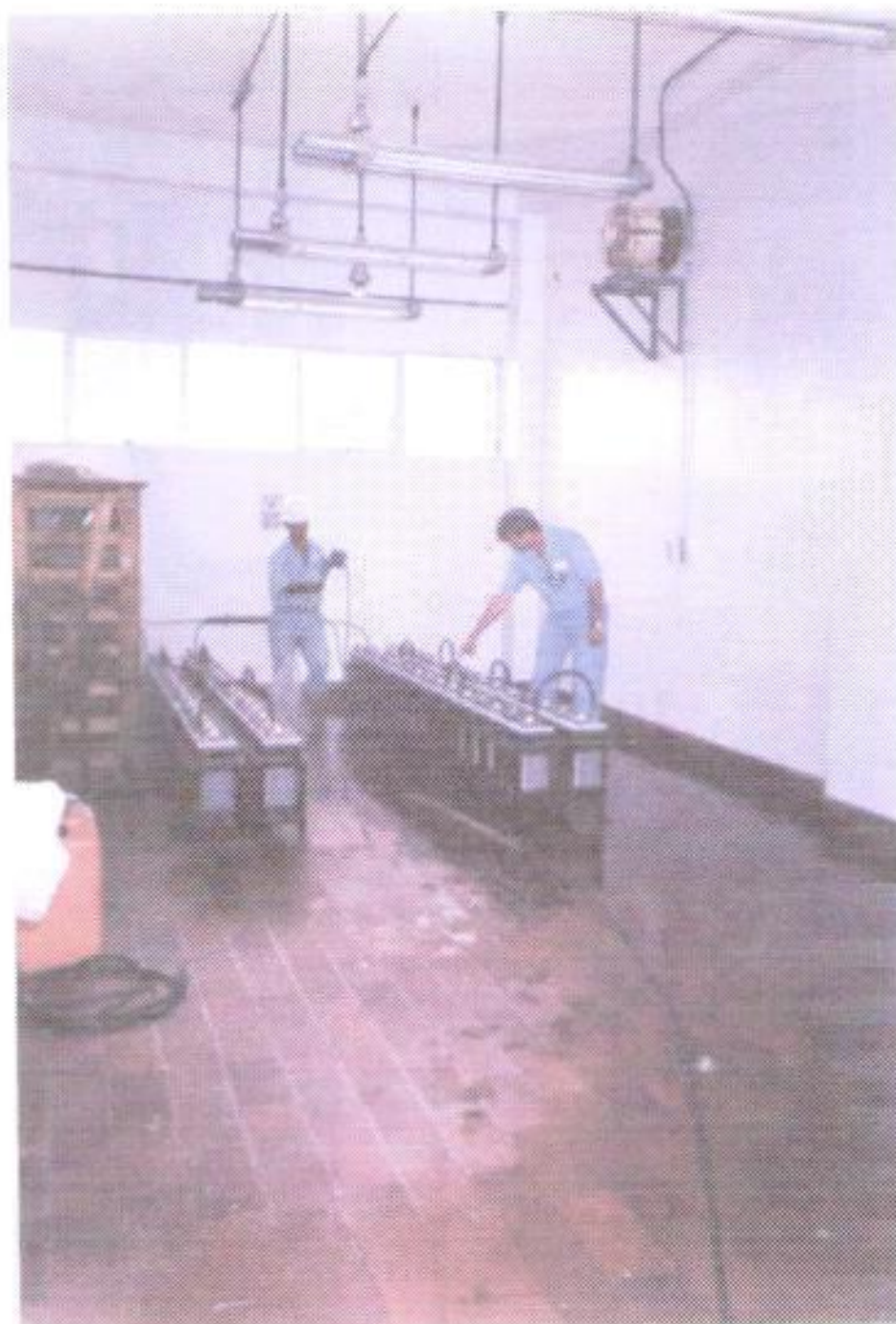
FIG. 5.19 Mantenimiento preventivo CUARTO de BATERIAS: limpieza general
