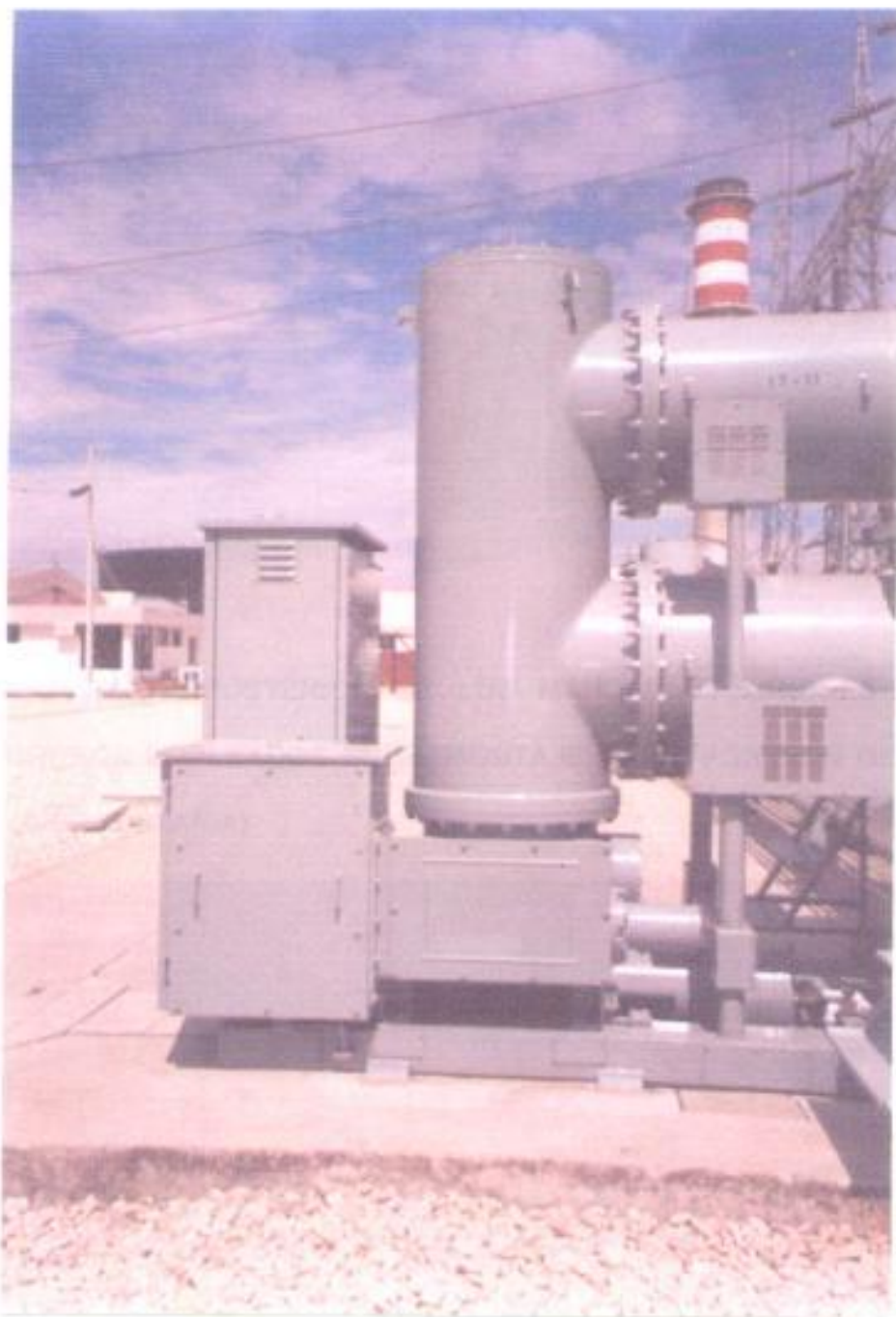
FIG. 20 VISTA LATERAL DISYUNTOR POSICION PVG 2 138 KV S/E TRINITARIA
