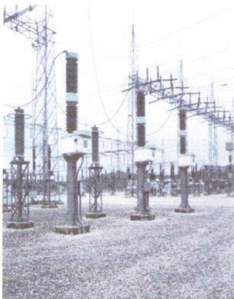
FIG. 5.12 Divisores capacitivos de potencial Nissin Electric 230 KV
