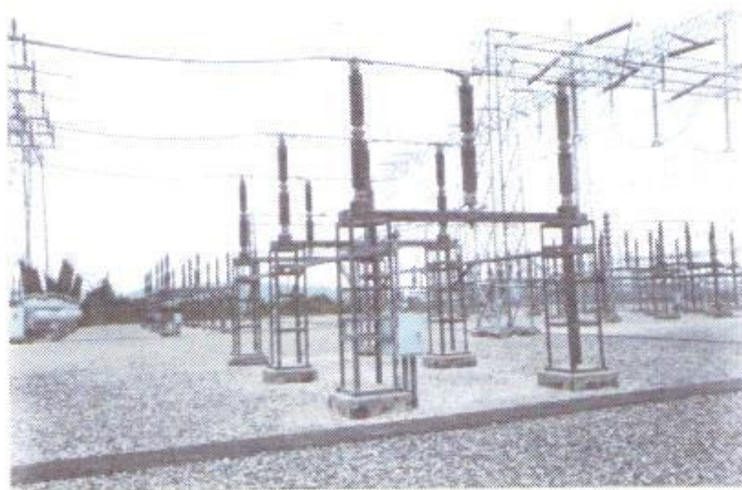
FIG. 5.7 Seccionador con mando motorizado General Electric 230 KV S/E Pascuales
