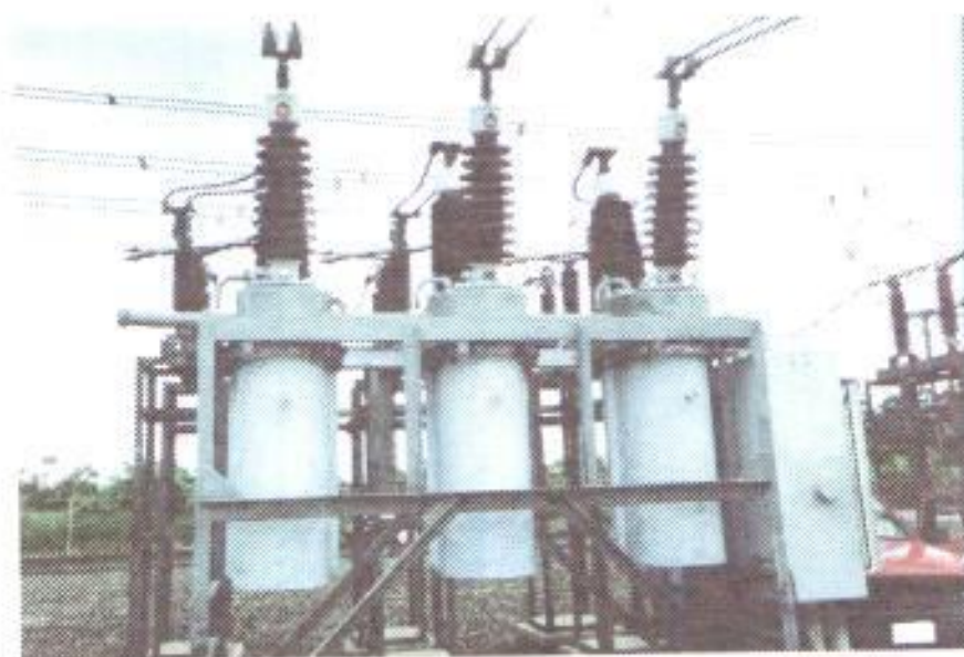
FIG. 5.6 Disyuntor Mitsubishi en aceite S/E Milagro 69 KV
