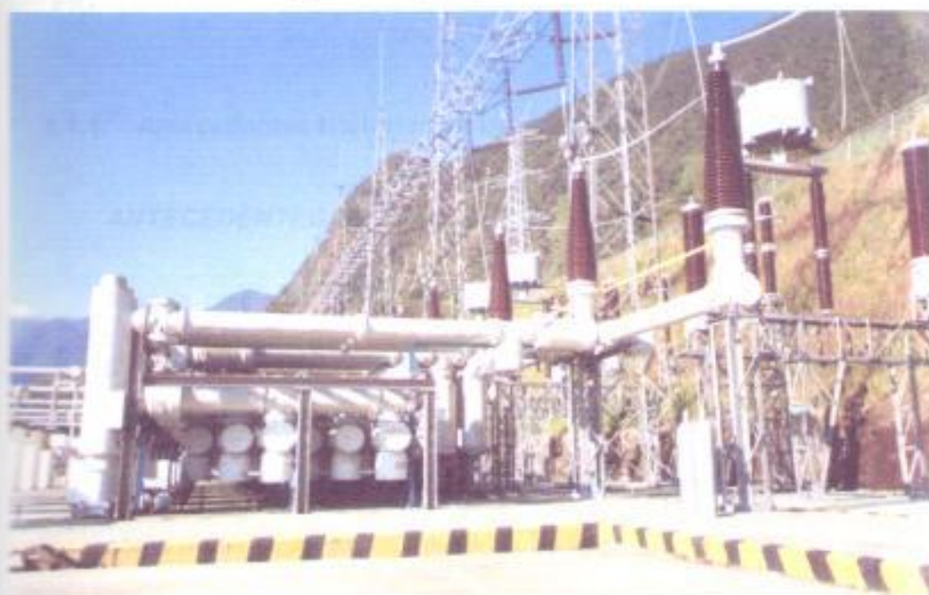
FIG. 4.2 Posición encapsulada (GIS) a 230KV Subestación Molino (Central Hidroeléctrica Paute)
