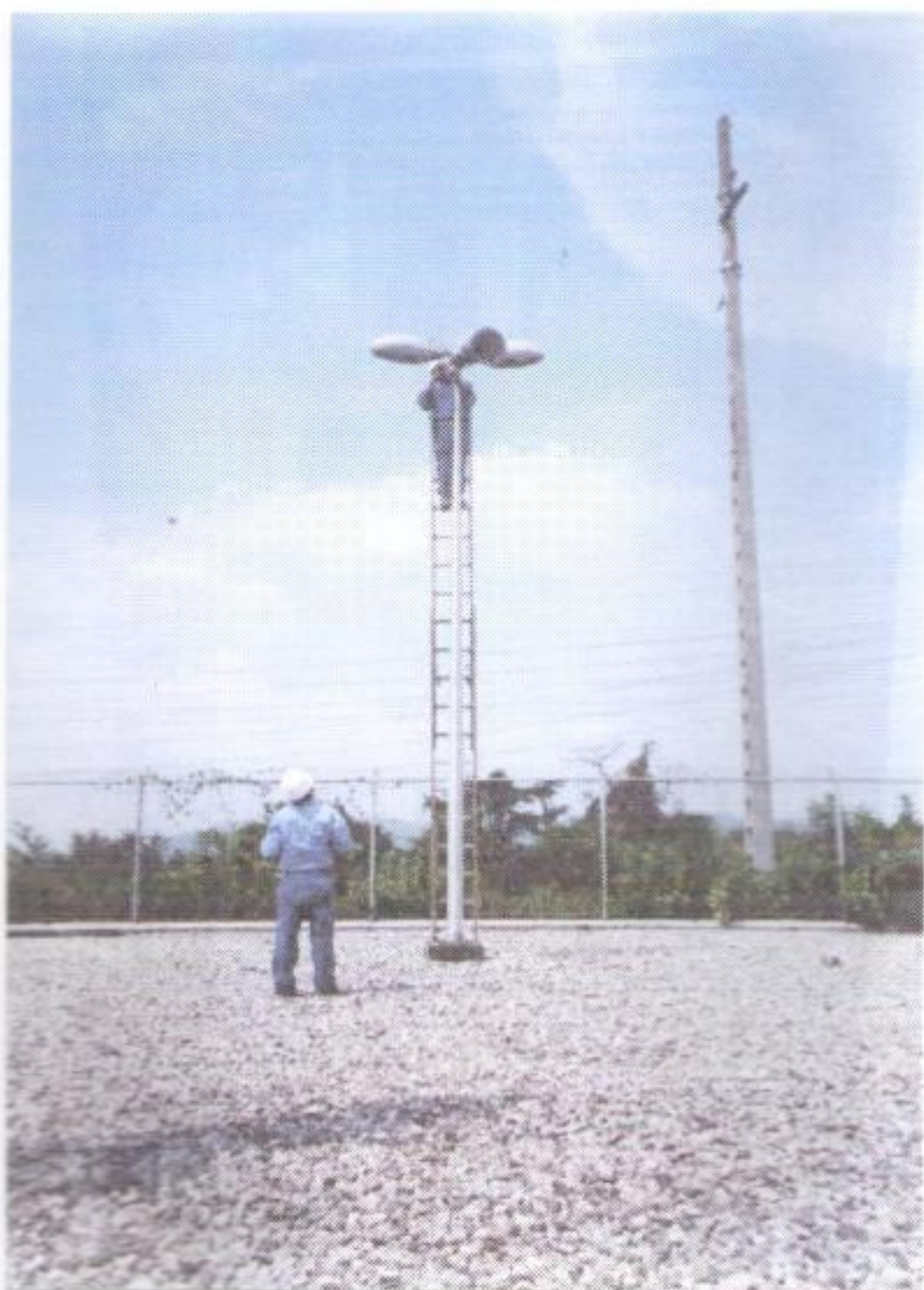
FIG. 5.21 Mantenimiento preventivo LUMINARIAS patio subestaciones eléctricas
