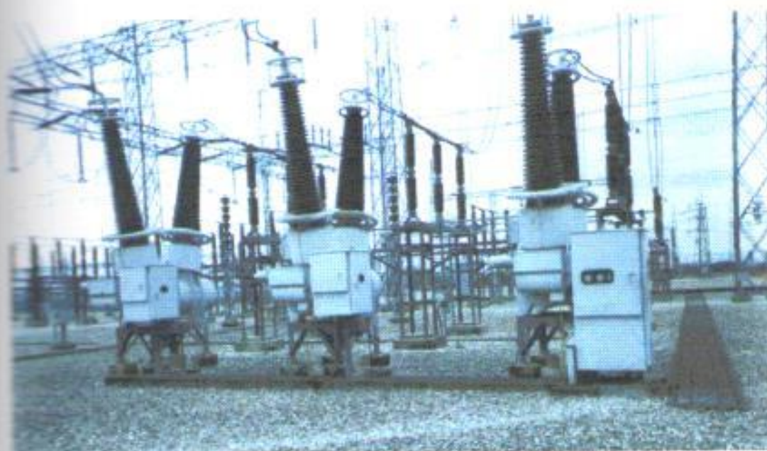
FIG. 2.3 Disyuntor Mitsubishi en SF 6 tipo PUFFER 230 KV
