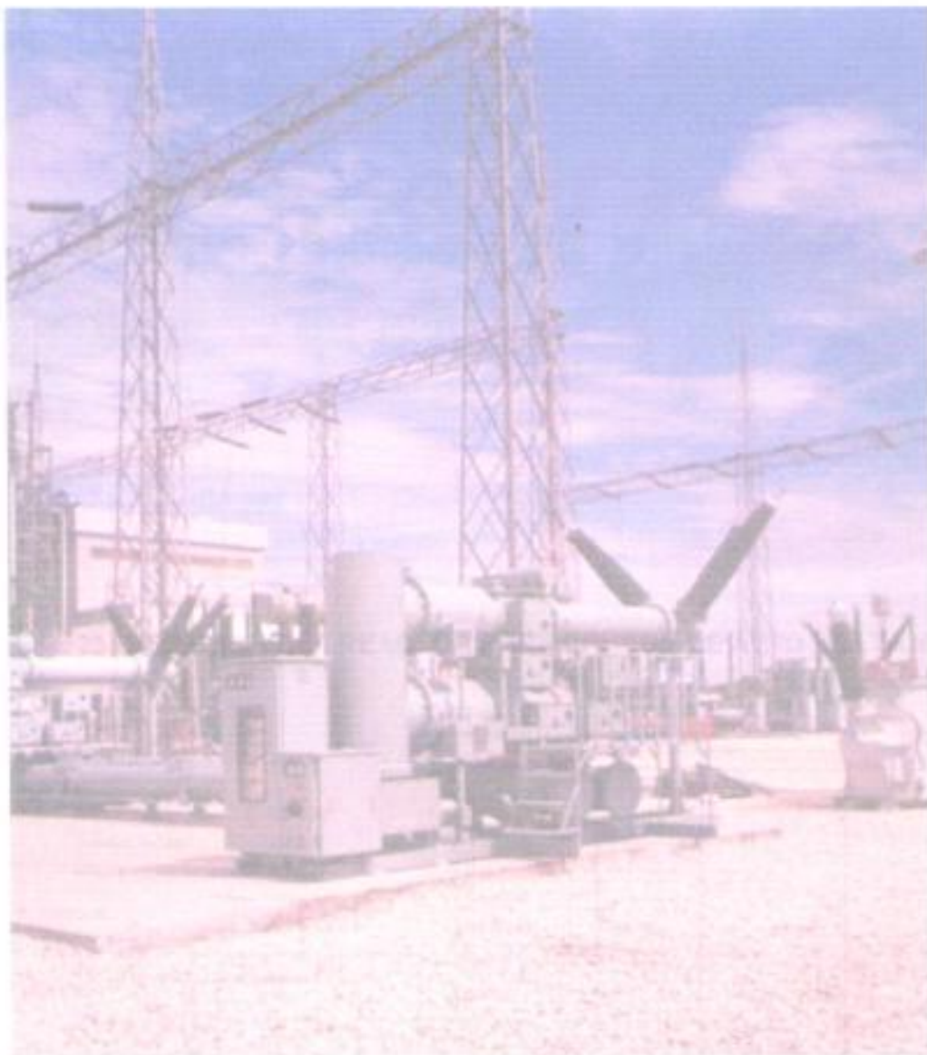
FIG. 22 VISTA POSICION PVG-2 138 KV GIS MITSUBISHI MONTADA COMPLETADAMENTE S/E TRINITARIA
