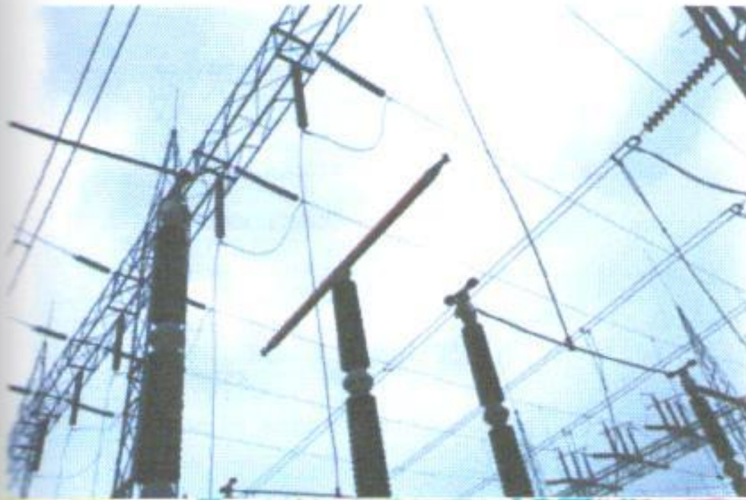
FIG. 2.4 Vista de cuchillas seccionadores 230 KV
