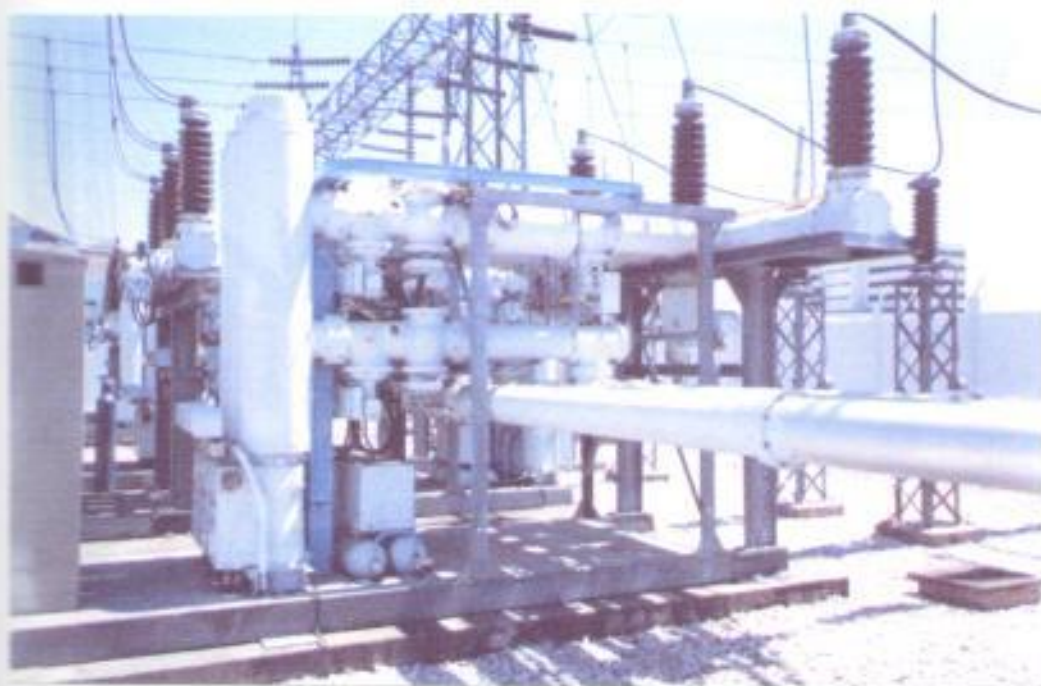
FIG. 4.1 Posición encapsulada (GIS) a 138 KV Subestación Policentro
