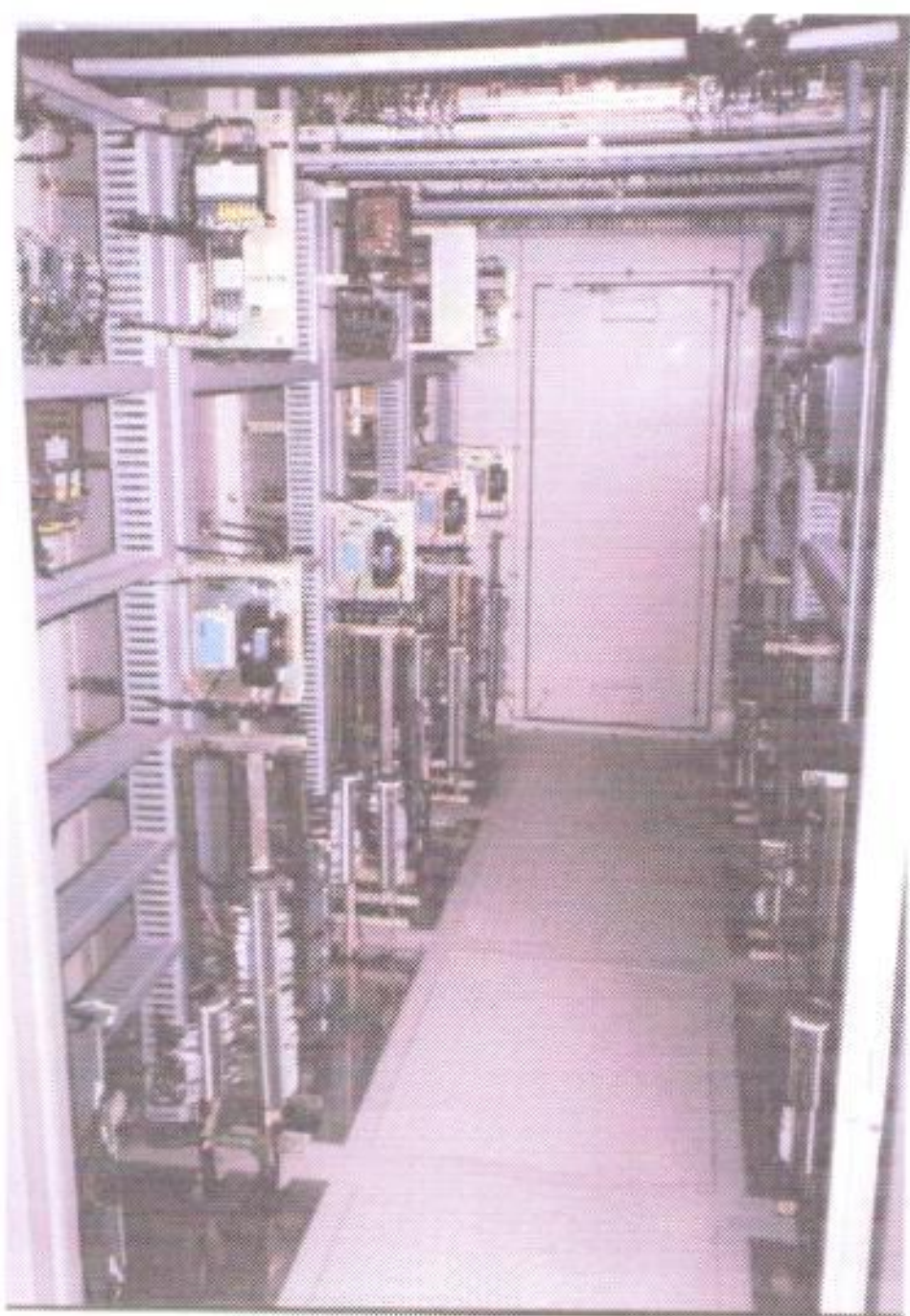
FIG. 5.22 Vista interior PANEL DUPLEX subestaciones eléctricas
