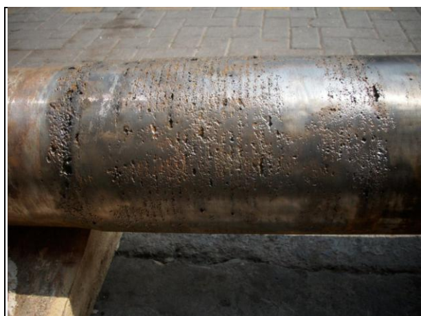
Figura 1.3.5: Pittings superficiales del eje
