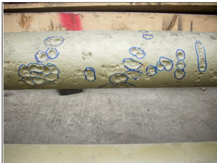
Figura 1.3.2: Socavaciones en el centro del eje
