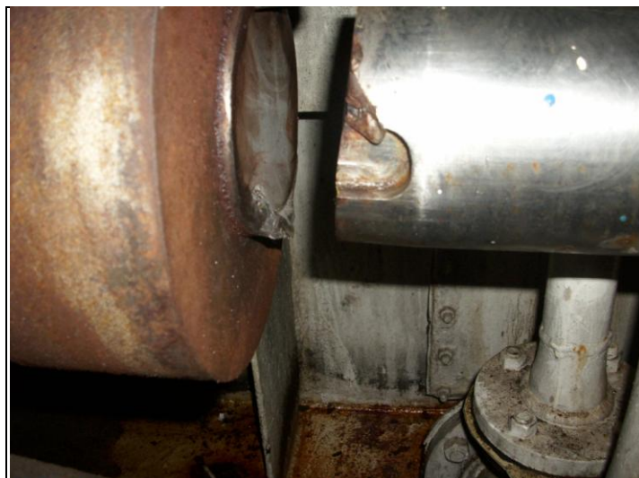
Figura 1.3.12: Rotura en la unión con la brida
