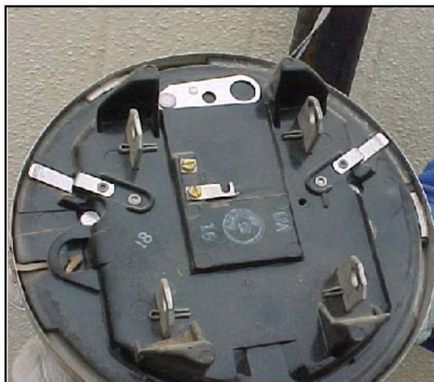
FIGURA 3.2: MEDIDOR CON PUENTE DE BOBINA ABIERTO.
