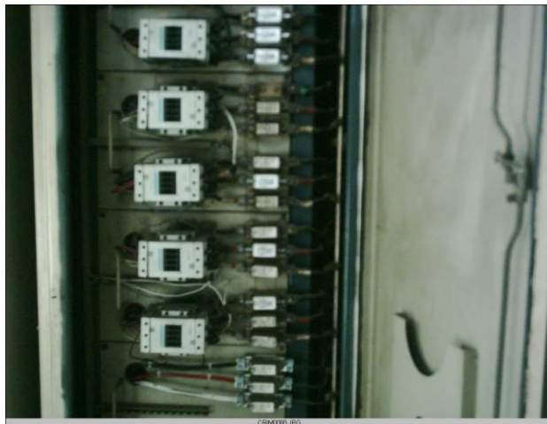
Figura 3 vista frontal Panel de control maquinarias
