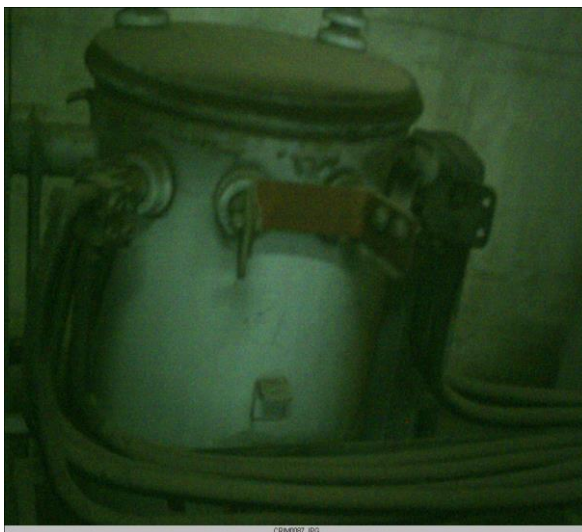
Figura 2 Área de transformadores
