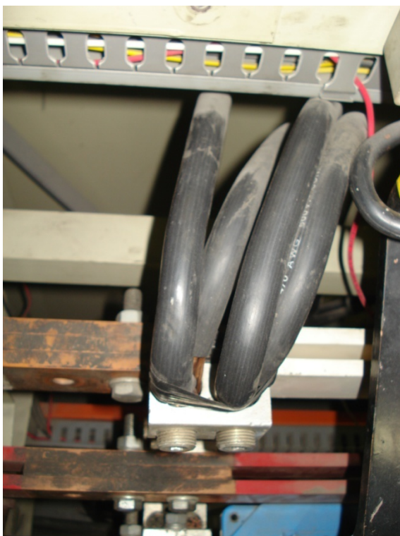
Figura 24.- Se observa la excesiva curvatura de los cables conectados a la barra, se observa también acumulación de polvo sobre las barras
