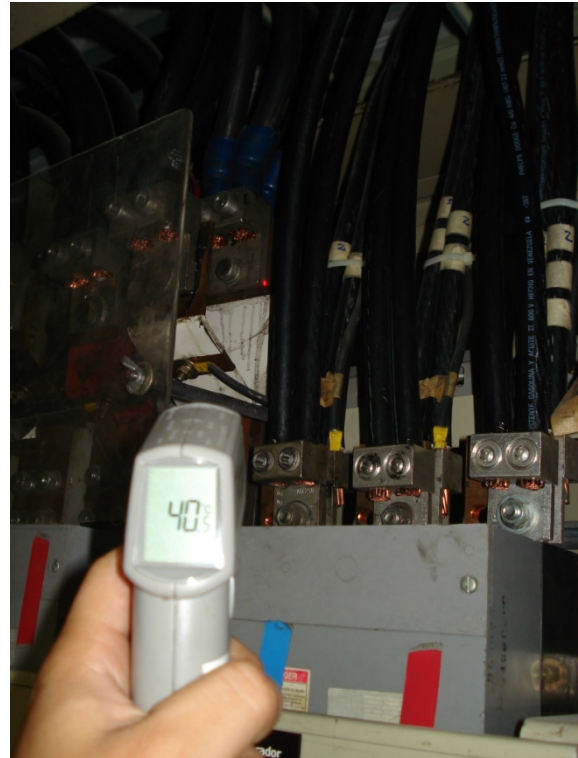
Figura 25.- Temperatura medida en los terminales de entrada del breaker del tablero
