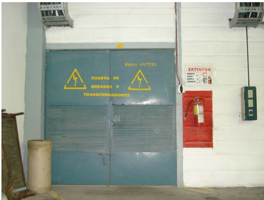
Figura 18.- Puerta de acceso al interior del cuarto donde esta ubicado el tablero de distribución de Senefelder
