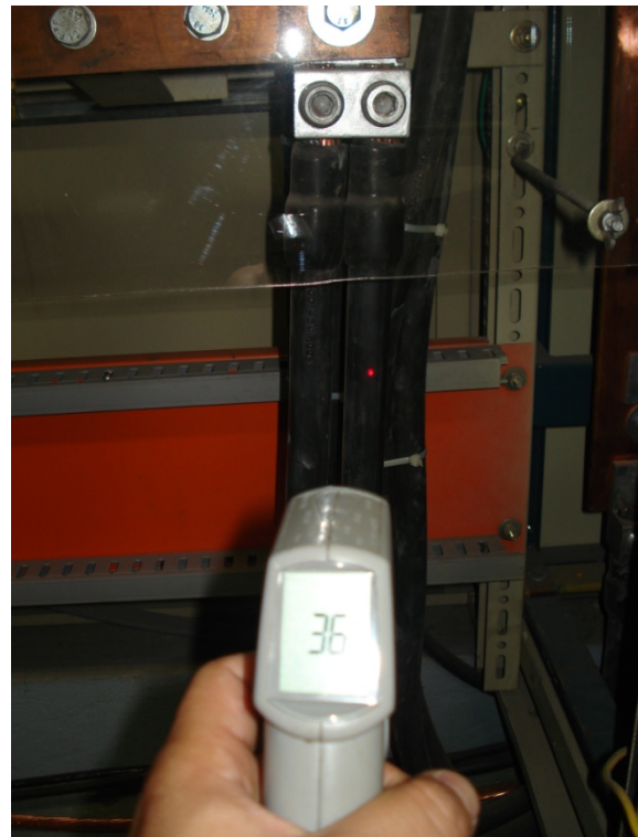
Figura 26.- temperatura medida en uno de los juegos de cables conectados a las barras.
