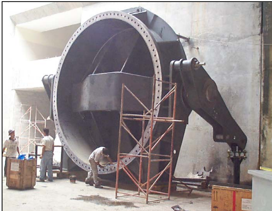
Figura 3.1. Válvula mariposa previa a su instalación.
