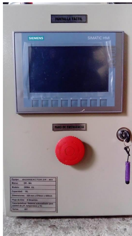
Figura 2-26 Parte frontal del tablero de control: Interfaz gráfica
