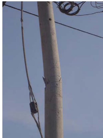
Figura # 4.12 Poste en mal estado
