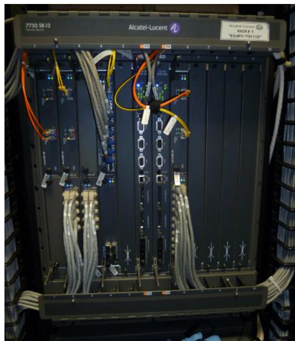
Figura 3.17 Equipo Alcatel-Lucent 7750 SR-12.
